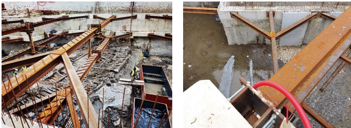
Figura 3.6 – Cenário construtivo da zona norte da escavação (à esquerda); Folga da ligação necessária à colocação do macaco para aplicação de pré-esforço (à direita)
