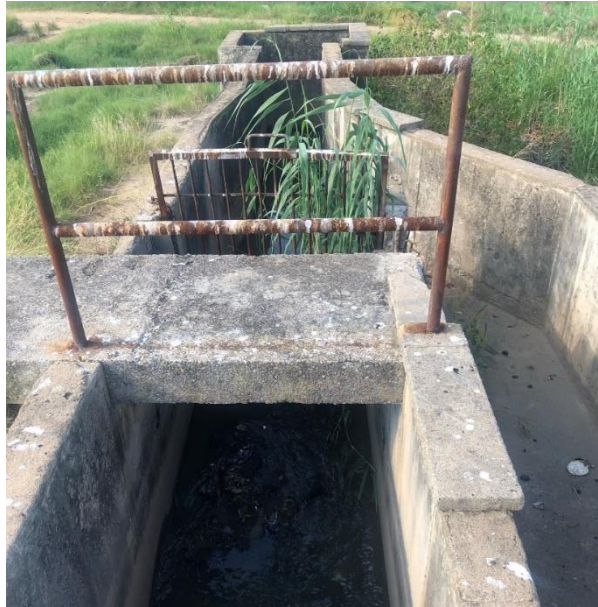
Figura 3.11 - Fotografia da obra de entrada da ETAR de Maputo
