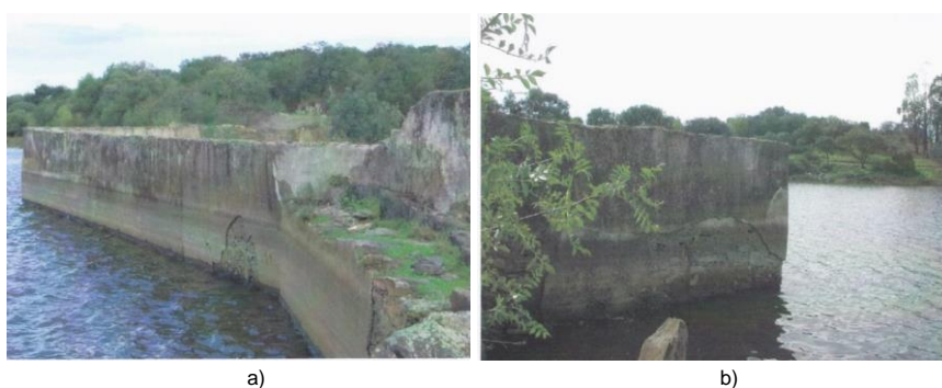
Figura 3.5 – Erosão do reboco do paramento de montante da barragem do Monte Branco :a) junto ao NPA e b) vértice da poligonal do corpo da barragem (retirado de Tetraplano, 2002).
