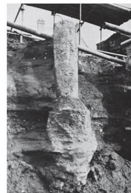
Figura 3.8 – Defeito na estaca provocado por bolsas de ar (Fleming, et al., 2009).
