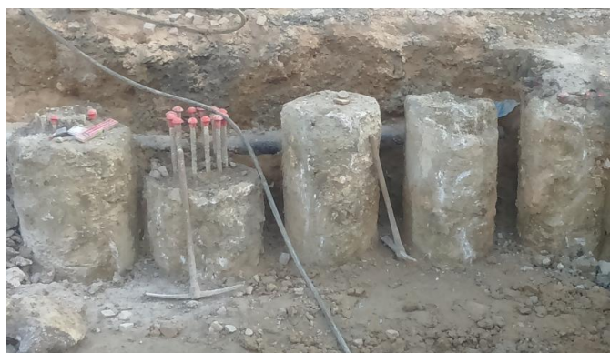
Figura A. IV 12 – Limpeza da cabeça das estacas, secção 2 do alçado AB
