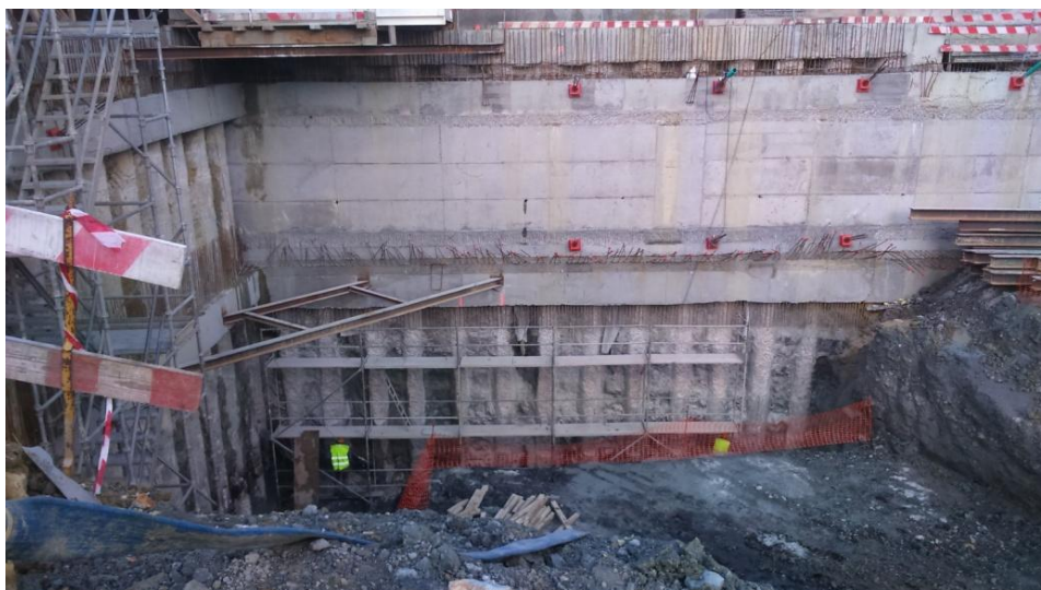
Figura 3.10 Vista do alçado GA com as ancoragens dos níveis 0 e -1 e início da construção da parede.
