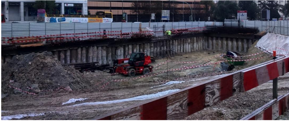
Figura A. IV 22 – Vista do recinto da obra, em especial alçado AB e BC
