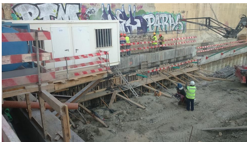
Figura A. IV 17 – Alçado GA com a cofragem da viga de distribuição e escoramento metálico
