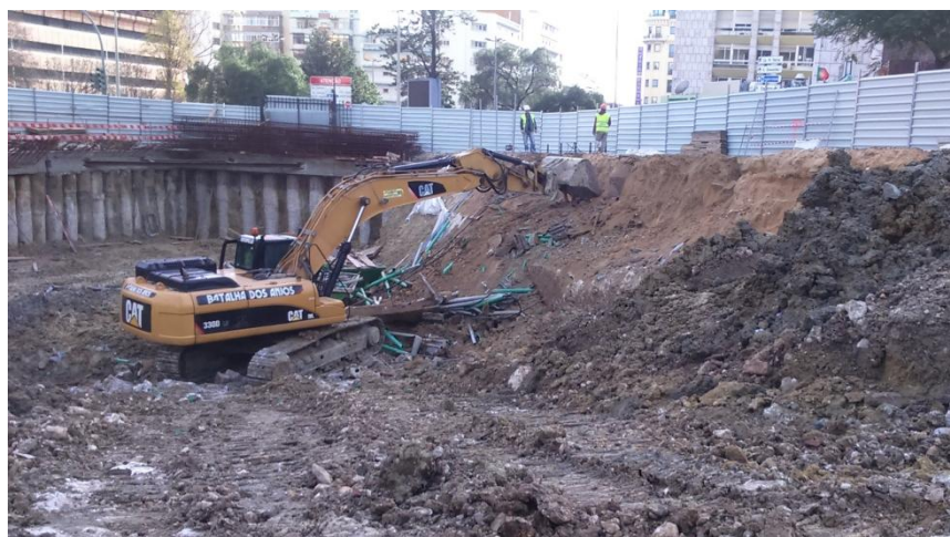
Figura A. IV 25 – Remoção do solo com recurso a retroescavadora no alçado EF
