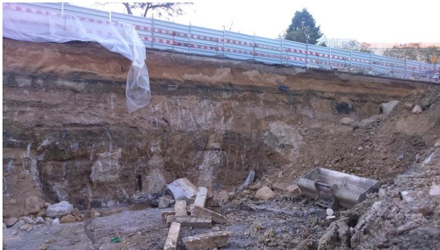
Figura A. IV 29 - Imagem demonstrativa dos trabalhos de escavação junto à parede de contenção do parque EMPARK
