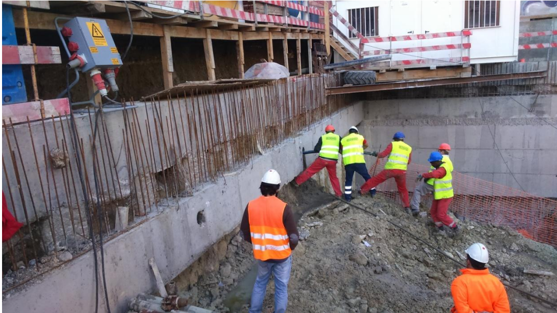
Figura A. IV 24 – Colocação manual dos cabos das ancoragens de 1º nível do alçado FG
