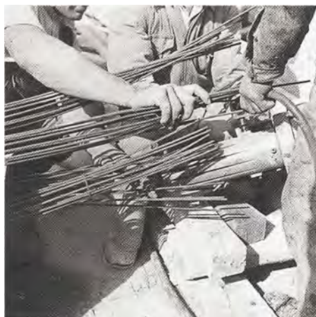
Imagem 17 – Amarramento os ferros da estrutura em betão armado durante a construção do edifício
