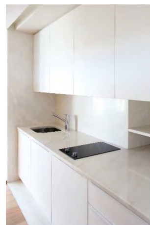
Imagem 95 - Kitchenette de apoio com placa vitrocerâmica, lava loiças embutido em aço inox e base de bancada a mármore
