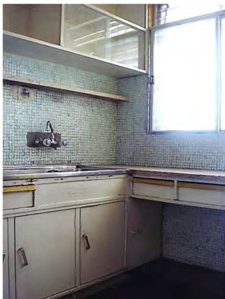
Imagem 28 – Situação da Cozinha antes do projecto de reabilitação. Armários inferiores e superiores originais pintados a branco. Revestimento do paramento com mosaicos vitrificados originais
