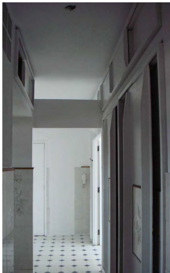
31 – Zona de circulação adulterada por adição de novos revestimentos
