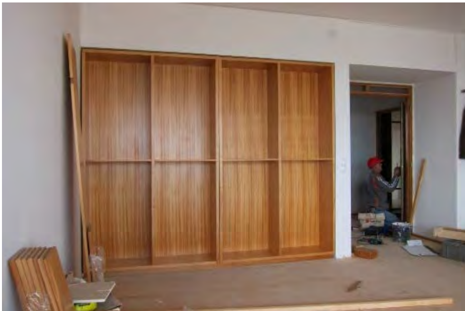
Imagem 41 – Aproveitamento da profundidade do sistema de divisão anterior para armário voltado para zona de circulação e estante para a sala, fase de obra (Janeiro, 2011)
