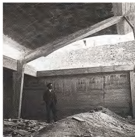
Imagem 16 – Processo de Construção de um dos ateliers com abobada em tijolo furado e armado
