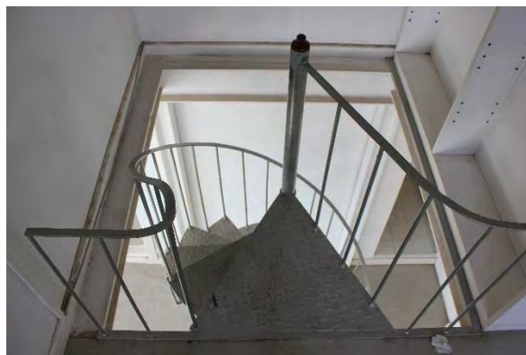
108 – Escadas de acesso ao piso superior acrescentado;
