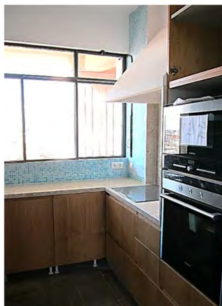
Imagem 37 – Cozinha do apartamento durante fase de obra, armário em MDF hidrófugo lacado. Campânula redesenhada (Janeiro, 2011)
