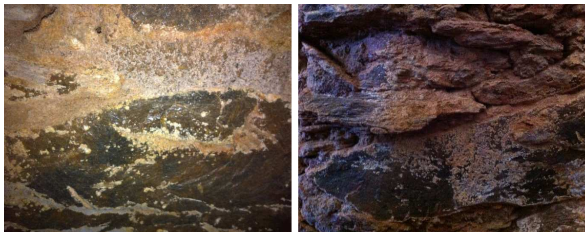
Figuras 2.10 e 2.11 – Anomalia verificada numa parede interior de alvenaria de xisto numa casa de habitação ( piso térreo) no concelho de Alandroal.
