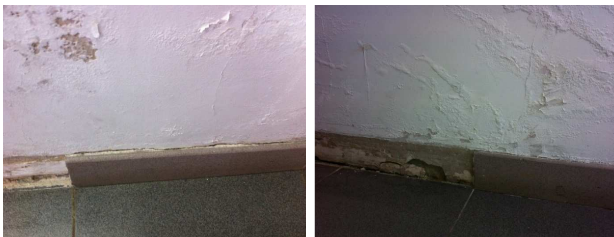
Figuras 2.14 e 2.15 – Anomalia verificada no paramento interior duma parede exterior dum refeitório (piso térreo) no concelho de Cascais.
