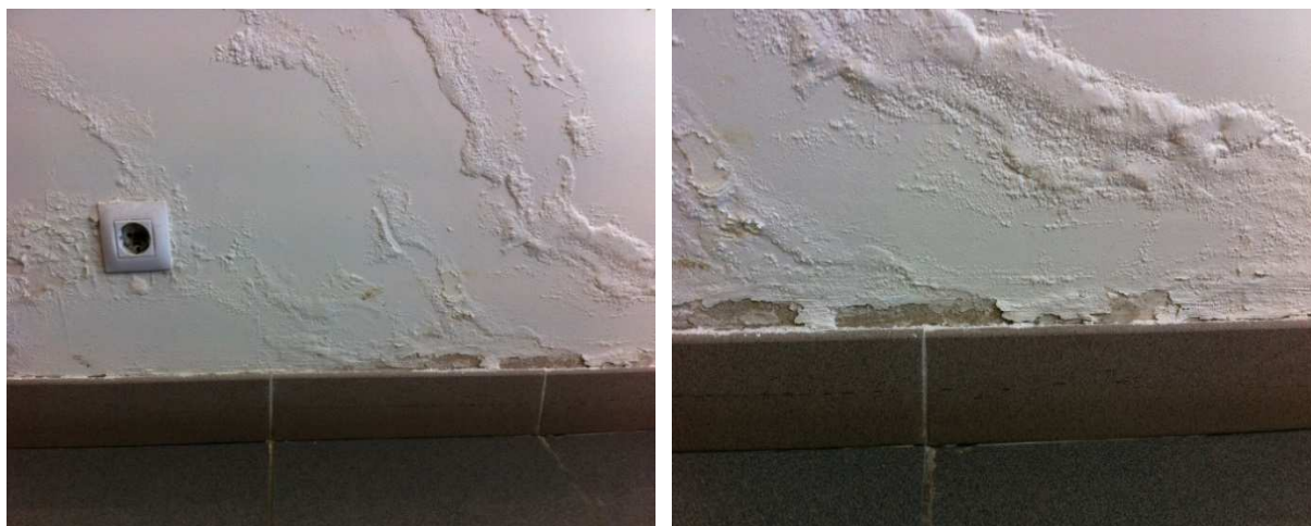
Figuras 2.12 e 2.13 – Anomalia verificada no paramento interior duma parede exterior dum refeitório (piso térreo) no concelho de Cascais.
