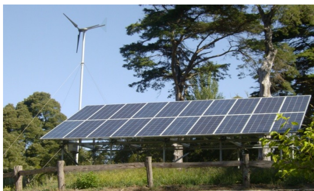
Figura 60 – Aerogerador e sistema solar fotovoltaico da QM – PSML
