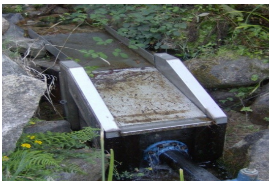
Figura 61 – Captação de água da QM – PSML
