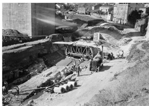
b) Construção do caneiro de Alcântara – Obras de cobertura da ribeira de Alcântara
