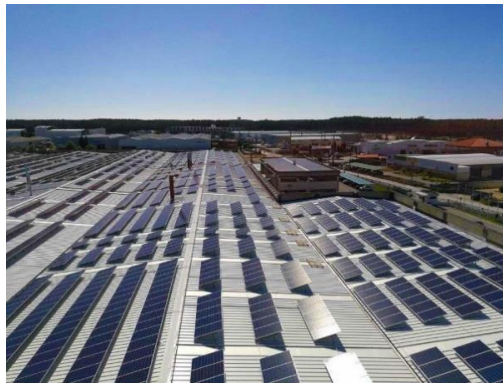
Figura 3-2: Instalação FV no telhado de uma instalação industrial [22].
