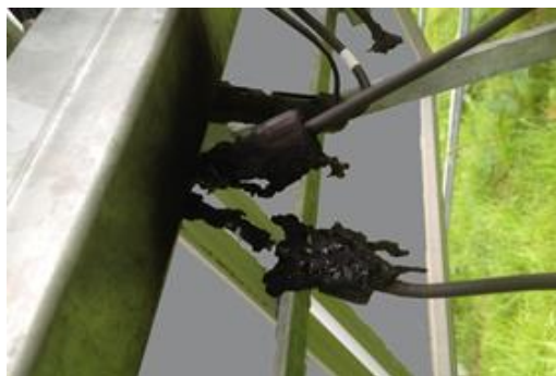
Figura 5-12: Conectores queimados devido à escolha errada dos conectores [91].
