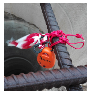
Figura 3.3: Fotografia do Sensor 17 no dia da instalação, na grelha do topo da CPV22 1a (superfície).
