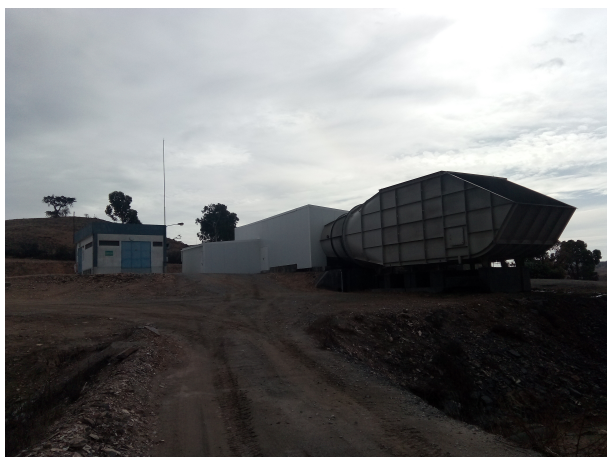
(a) Chaminé de exaustão forçada
