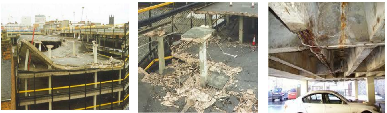
Figura 2.8 (a) Pipers Row Car Park após o colapso da laje da cobertura; (b) Destroços provocados pela rotura por punção num dos pilares do último piso; (c) Corrosão das armaduras [9] e [Google]
