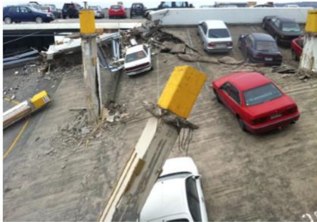
Figura 2.9 Parque de estacionamento de um edifício em Christchurch sujeito à acção sísmica [13]
