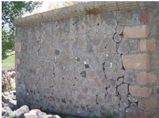
Figura 6 - Fendilhação entre panos de alvenaria ortogonais (Bayraktar & Yalçin, 2007).
