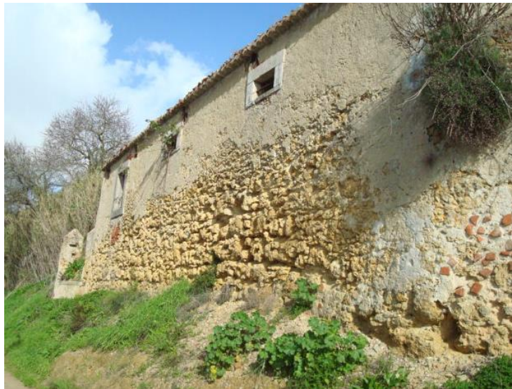
Figura 7 - Desagregação do reboco devido à humidade do terreno (Appleton, 2008).
