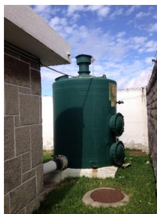
Figura A.4- Torre de carvão ativado para redução de maus odores da EE de São Pedro
