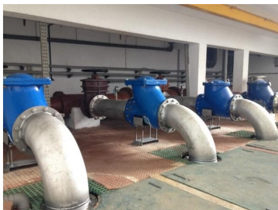
Figura A.1- Grupos eletrobomba da EE do Jamor
