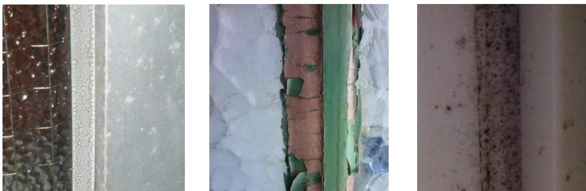
Figura 3.2 - Alteração da cor / degradação superficial do vedante (à esquerda), deterioração do revestimento da massa de vidraceiro (ao centro) e colonização biológica do vedante (à direita)
