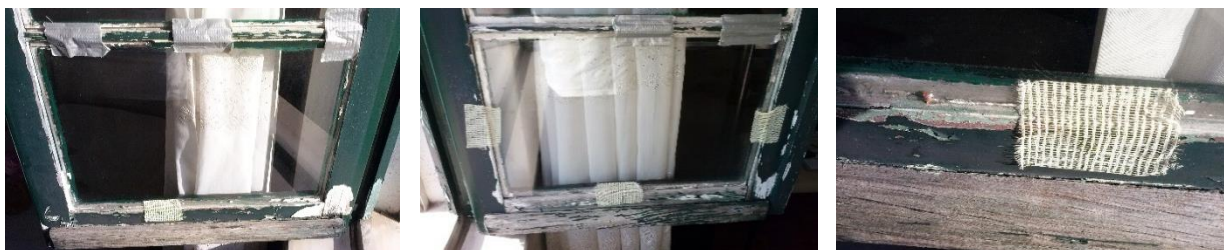
Figura 4.9 - Caixilharia de madeira com um valor muito elevado de degradação
