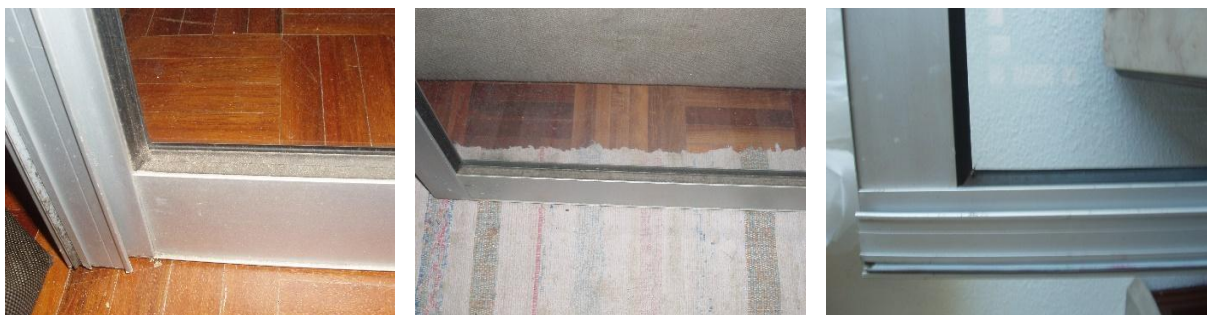
Figura 3.8 - Caixilharias de alumínio de 1985 que apresentam um estado de degradação muito inferior ao esperado
