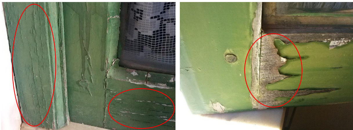
Figura 4.2 - Sobreposição dentro do grupo de anomalias, no revestimento e no material do caixilho: fissuração e alteração da cor do revestimento (à esquerda); destacamento do revestimento e envelhecimento da madeira (à direita)
