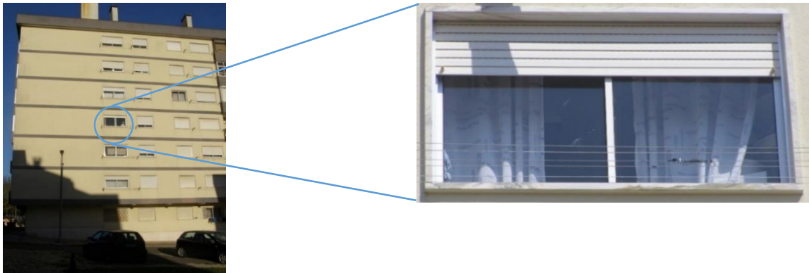
Figura 3.1 - Dificuldade de visualização da totalidade da caixilharia quando inspeccionada pelo exterior em altura
