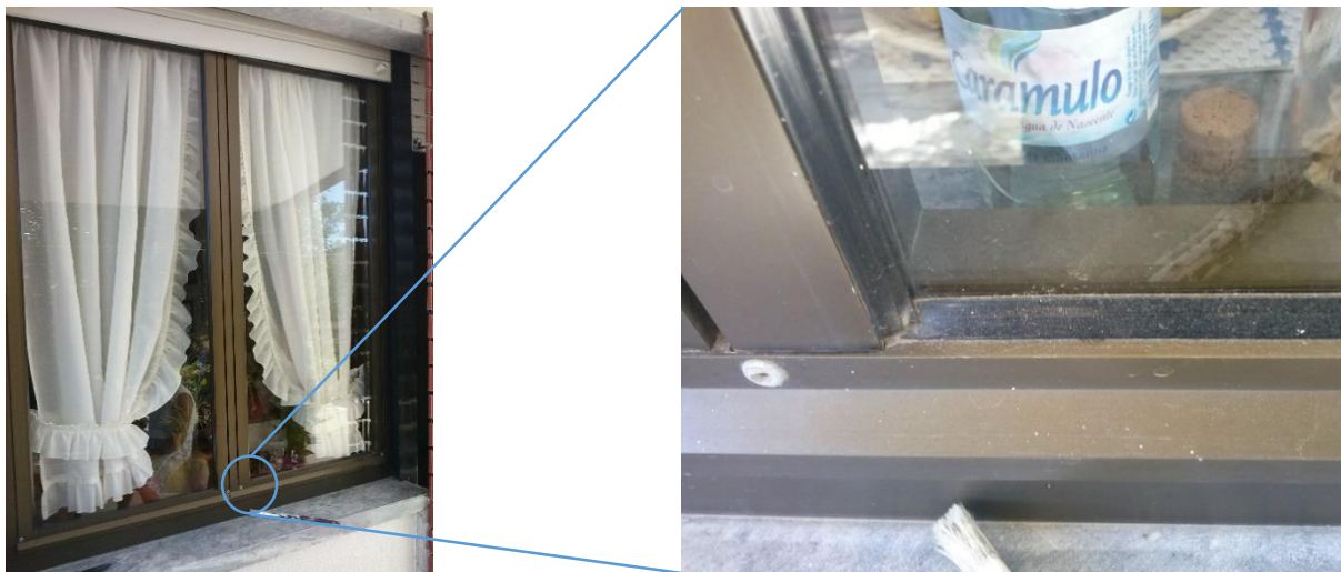
Figura 3.7 - Caixilharia de alumínio de 1985 que apresenta um estado de degradação anómalo
