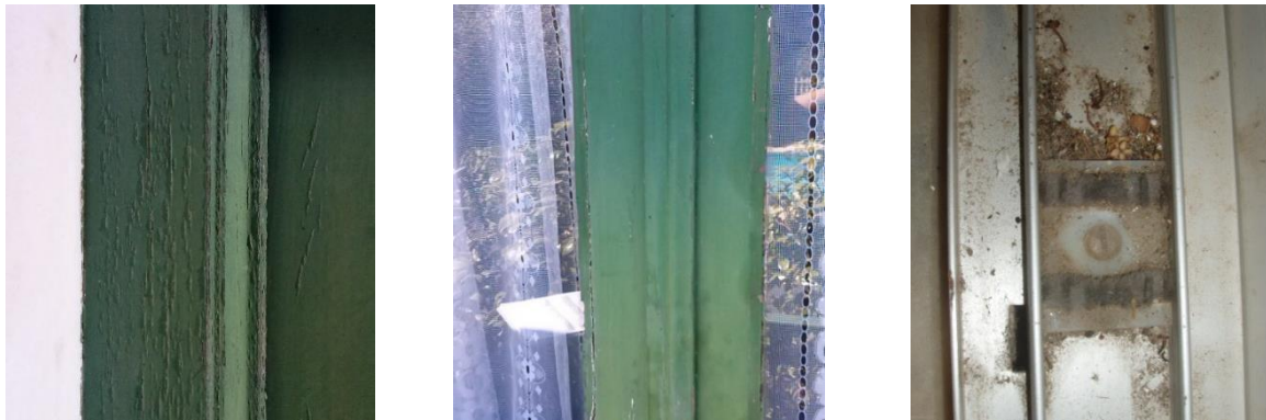
Figura 3.5 - Fissuração do revestimento (à esquerda), alteração da cor do revestimento (ao centro) e acumulação de sujidade no aro fixo inferior (à direita)
