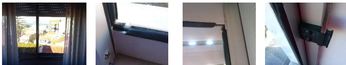
Figura 4.6 - Pormenores da caixilharia de alumínio próxima do fim de vida útil
