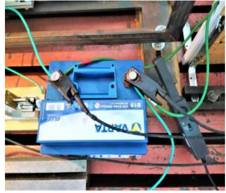
(c) Pinças de medição de corrente da carga e de tensão da bateria.
