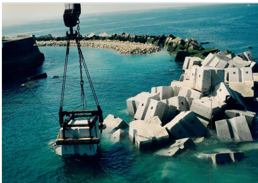
Figura 17: Farol do Bugio em 1998. Colocação dos blocos antifer. Foto cedida pelo Eng.º Lopes de Castro.
