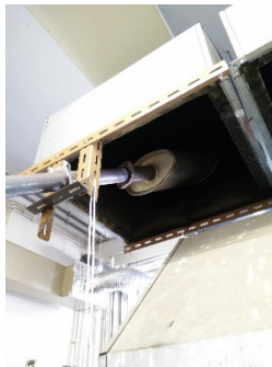
Figura 3.10 - Panela de escape e exaustor
