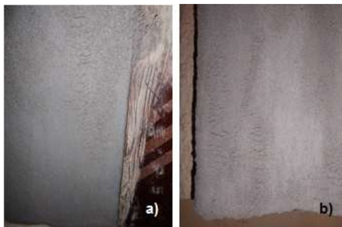
Figura 5.7 - Pormenor da retracção da argamassa PCM-SB-5, no estado fresco (a) e no estado endurecido (b).
