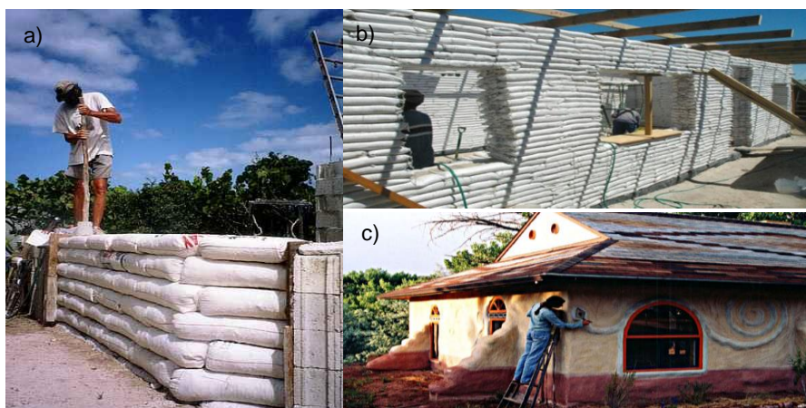
Figura 11 – a) Compactação de uma fiada de uma parede. b) e c) Exemplo de construção de edifícios com paredes verticais em terra ensacada (Geiger et al., 2014).
