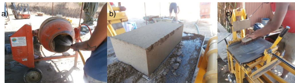
Figura 29 – Pormenores na moldagem dos BTC: a) Lavagem da betoneira. b) Pormenor dos danos resultantes da desmoldagem. c) Limpeza dos pratos da prensa.
