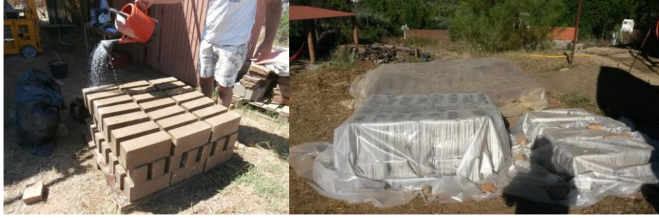
Figura 17 - Cura dos blocos: Blocos tapados com lona plástica após rega com água.
