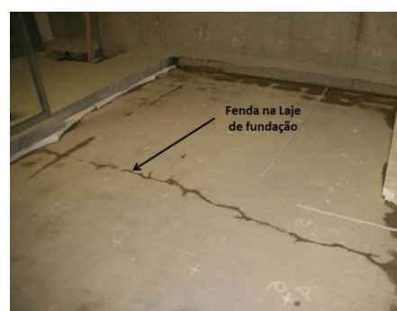
Figura 2.34 – fenda na laje de fundação [Schabowicz et al., 2013]
