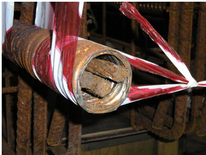
Figura 3.10 – Corrosão das armaduras e bainha de pré-esforço. [Almeida et al., 2013]
