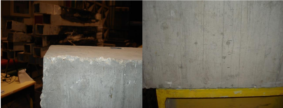
Figura 4.6 – Descascamentos e delaminações no protótipo A
