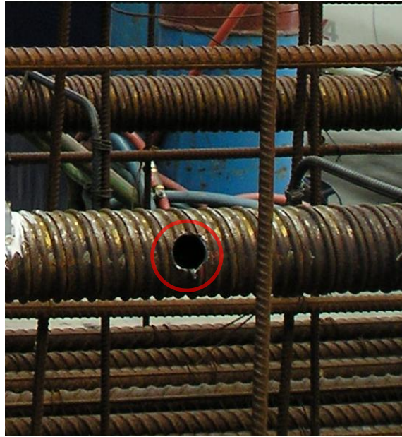
Figura 3.11 – Vazio na bainha assinalado a vermelho, onde será colocado um tubo transversal [Almeida et al., 2013].
