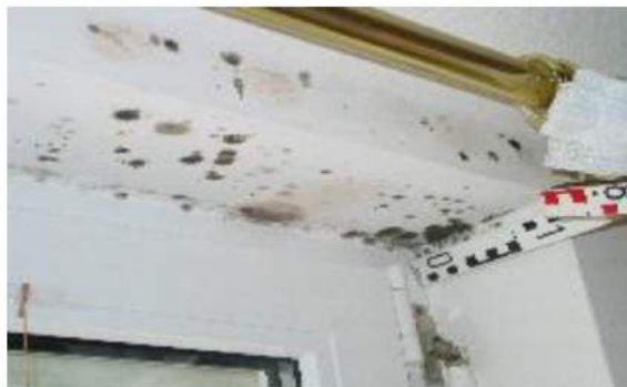
Figura 2.22 - Aparecimento de bolores potenciados por humidades em zona de ponte térmica da caixa de estore [46].
