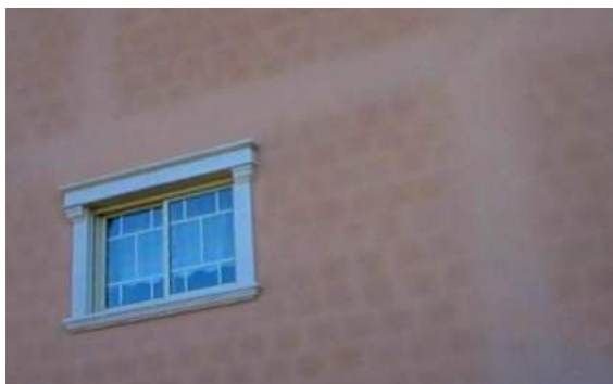
Figura 2.21 - Patologia construtiva originada por pontes térmicas [45].
