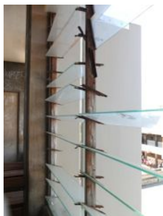
F.an.18 - Caixilharia com elementos deteriorados, motivando funcionamento muito deficiente ou eventuais acidentes. Anomalia média.
