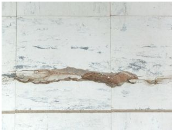
F.an.18 - Revestimento vinílico danificado devido aos movimentos da junta de dilatação da laje; Anomalia ligeira.
