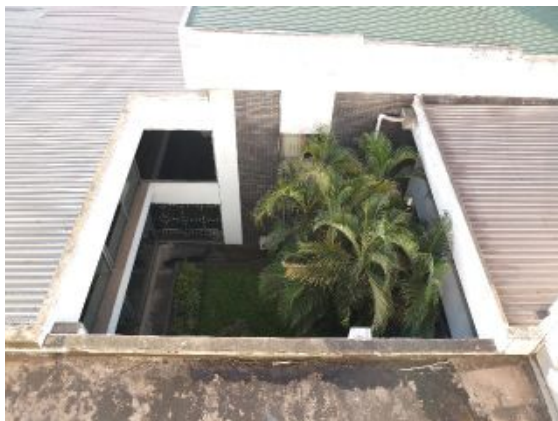
F.an.04 - Superfície de revestimento da cobertura enegrecida. Acumulação de detritos e sujeidade e ocorrência de colonização biológica; Anomalia ligeira.
