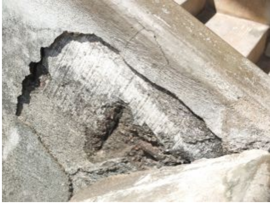
F.an.28 - Estrutura com perdas de material e destacamento do recobrimento de armaduras em áreas limitadas; Anomalia média.
