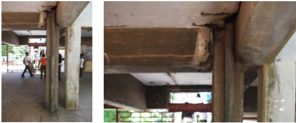
F.an.01 – Estrutura com armaduras à vista e com corrosão profunda, estrutura com fendilhação e perda de elementos.
