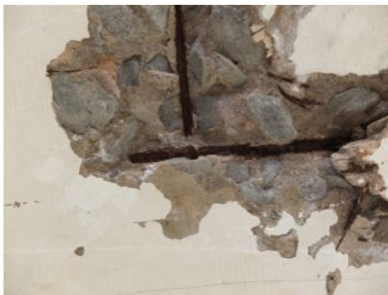
F.an.02 – Estrutura com destacamento do recobrimento de armaduras em áreas limitadas.
