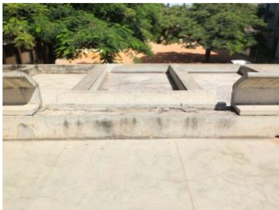
F.an.26 - Guarda pré-fabricada derrubada; Anomalia média.
