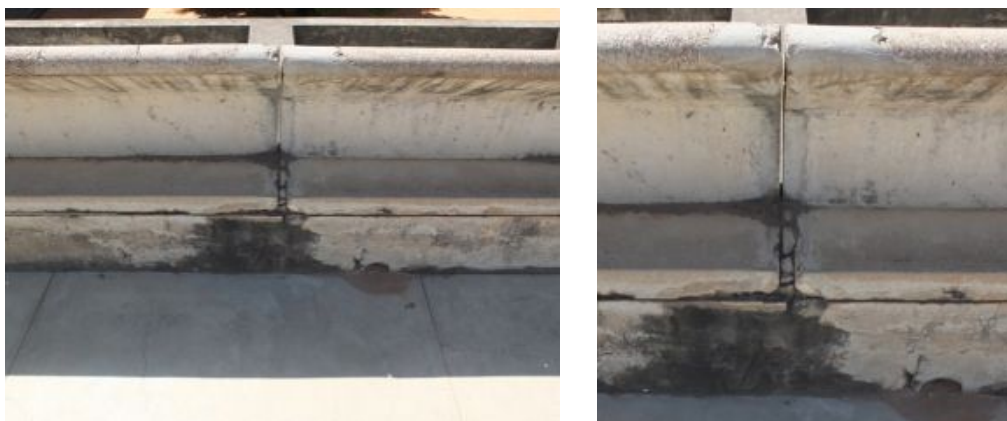
F.an.28 - Coloração do betão à superfície; Anomalia média.
