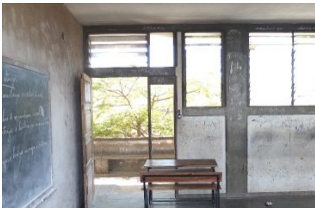
F.an.23 - Portas com elementos deteriorados ou removidos, motivando funcionamento muito deficiente e eventuais incidentes; Anomalia
