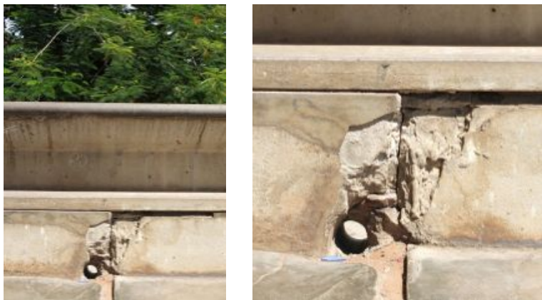
F.an.27 - Estrutura com perdas de material e destacamento do recobrimento de armaduras em áreas limitadas. Coloração do betão; Anomalia
