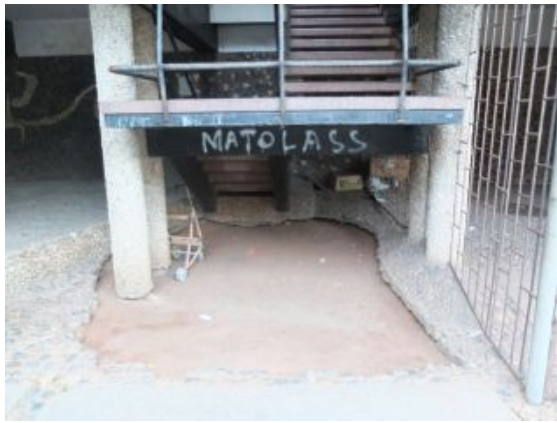
F.an.13 - Falta do revestimento do pavimento; Anomalia grave.
