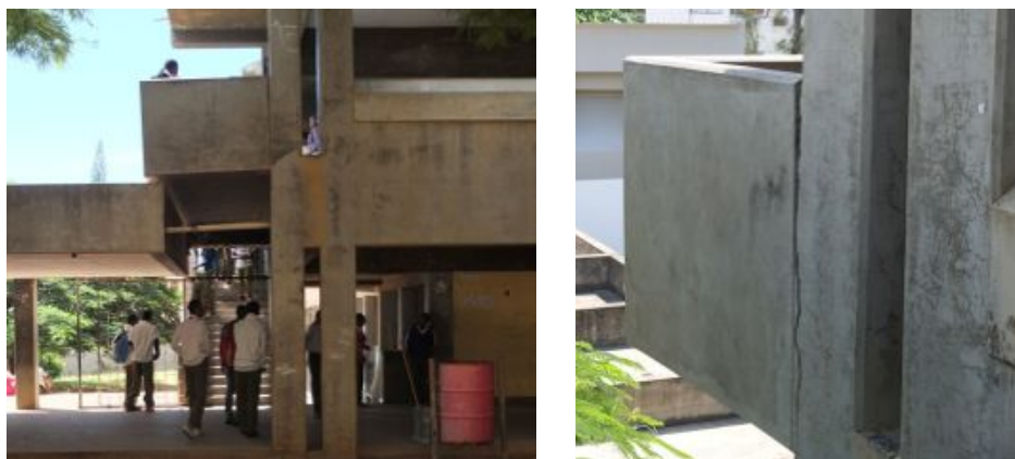
F.an.03 - Estrutura com fendilhação cuja localização, orientação e evolução indiciam risco de colapso parcial.
