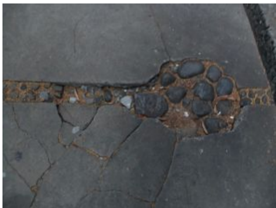
F.an.12 - Fissuração do revestimento do pavimento; Anomalia média.
