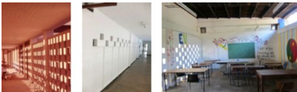
3.26 – Configuração original da parede do espaço onde funcionava o estendal. 3.27 – Configuração actual. 3.28 – O antigo estendal transformado em sala de aula.
