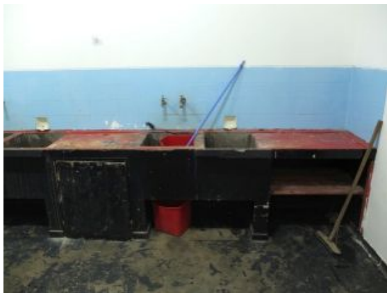
F.an.19 - Desgaste generalizado do revestimento do pavimento; Anomalia ligeira.
