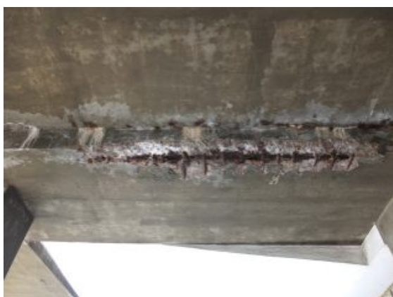
F.an. 06 - Fendilhação de grande extensão de pequena abertura que não indicia problemas estruturais: Anomalia média.
