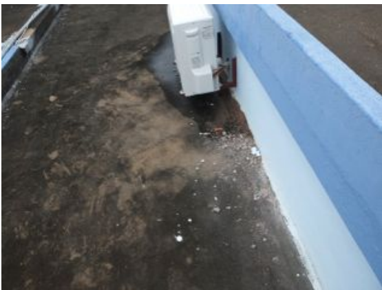
F.an.07 - Sujidade, manchas e depósitos, em parte associados à instalação de um equipamento de ar condicionado; Anomalia ligeira.
