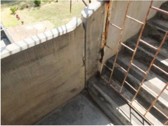
F.an.29 - Destacamento e perda de material; Anomalia ligeira.
