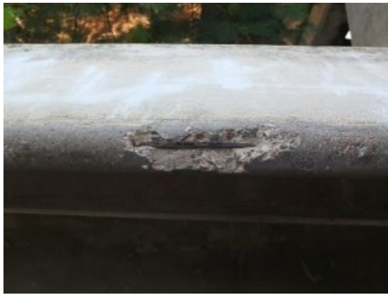
F.an.25 - Descasque pontual do recobrimento das armaduras; Anomalia média.
