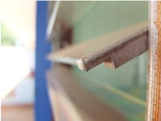
F.an.22 - Oxidação das caixilharias, permitindo o seu funcionamento; Anomalia ligeira.
