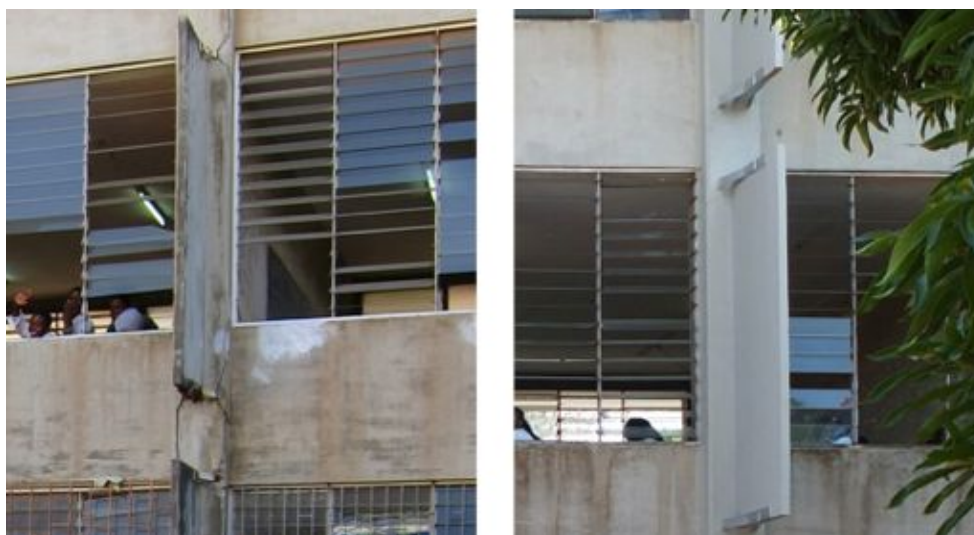
3.73 – Dispositivos brise-soleil antes e depois das intervenções de consolidação.
