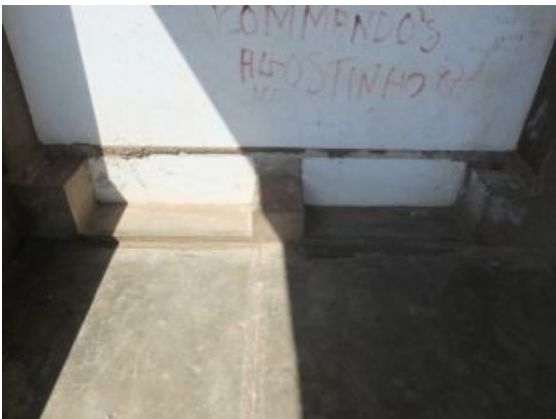
F.an.32 - Falta de elemento; Anomalia média.
