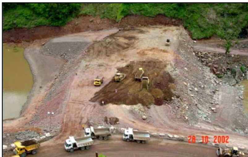
Figura 3.20- Barragem de Campos Novos (Brasil), ensecadeira de material granular (Rocha e Tamada, 2006).
