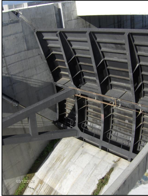
Figura 5.2- Comporta de segmento. Barragem do Alqueva (fotografia obtida em visita de estudo ao local).
