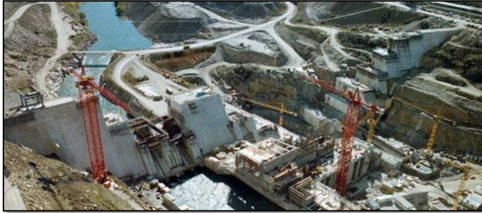
Figura 3.16- Barragem Clyde (Nova Zelândia). Caso prático em que se recorreu a este tipo de desvio provisório (Engenharia Civil.com)
