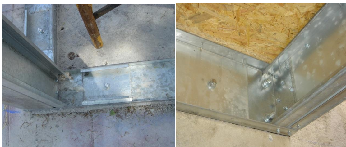
Figura 3.3 – Fixação de canal (a) à laje e (b) à parede, com bucha química
