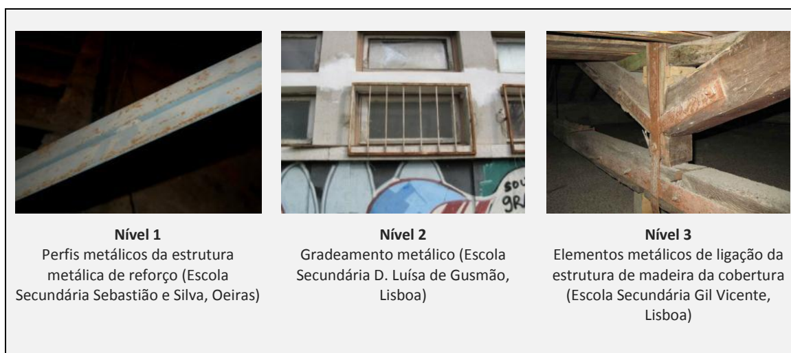
Figura 4.11 - Comparação visual de gravidades das anomalias A12 - Corrosão em diversos elementos metálicos.
