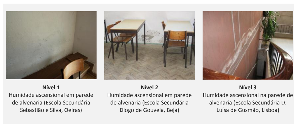
Figura 4.19 - Comparação visual de gravidades das anomalias A21 - Infiltrações.
