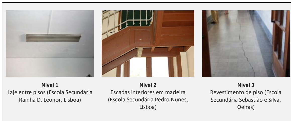
Figura 4.24 - Comparação visual de gravidades das anomalias A29 - Deformação excessiva / assentamentos.
