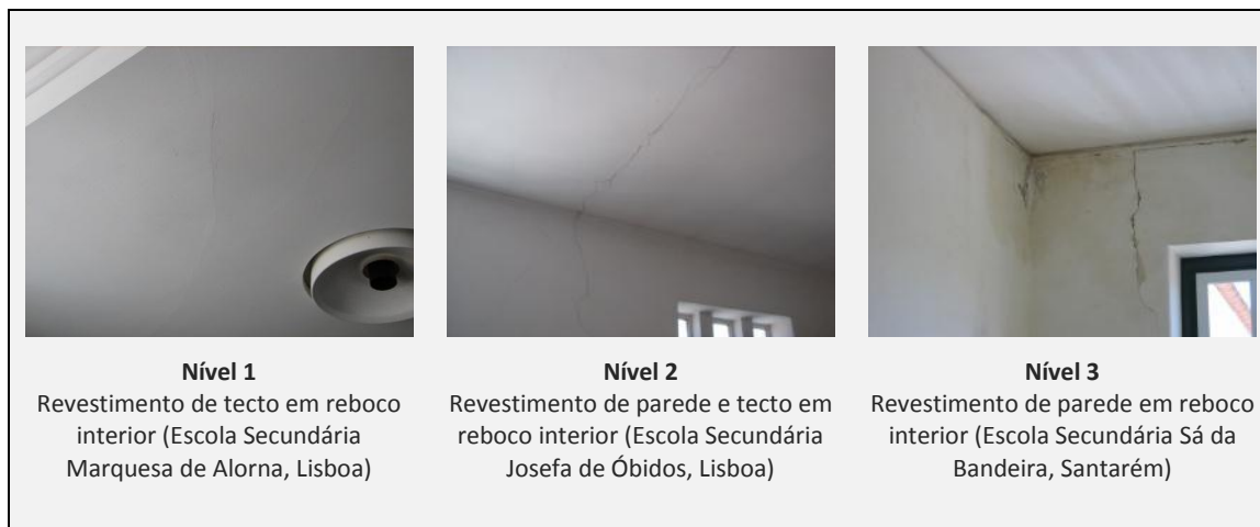
Figura 4.5 - Comparação visual de gravidades das anomalias A5 - Fissuração orientada.
