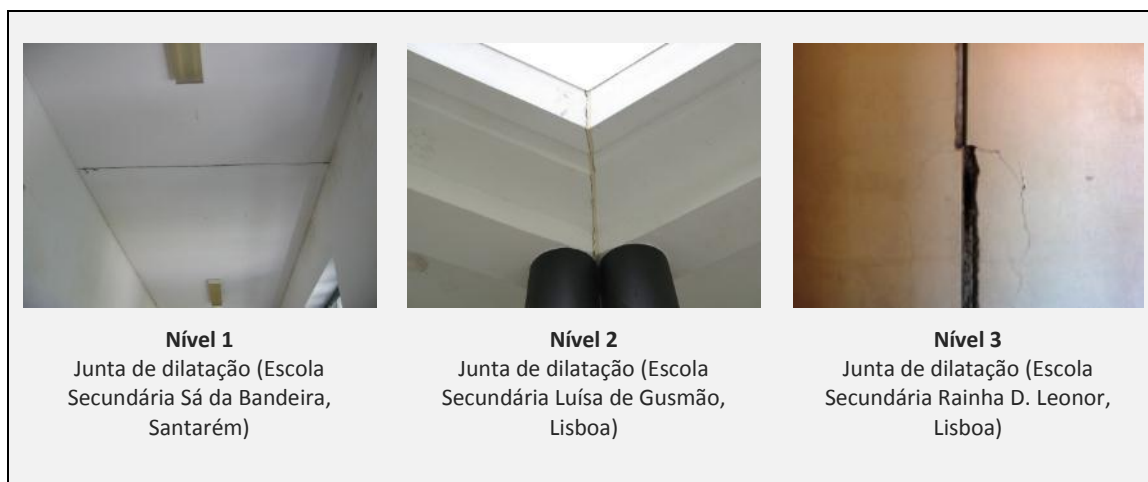
Figura 4.16 - Comparação visual de gravidades das anomalias A19 - Deficiente funcionamento de juntas de dilatação.
