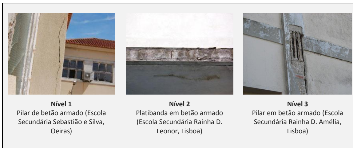
Figura 4.10 - Comparação visual de gravidades das anomalias A12 - Corrosão em armaduras de betão armado.
