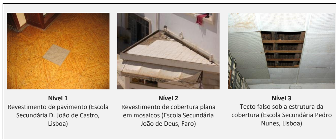
Figura 4.13 - Comparação visual de gravidades das anomalias A16 - Elemento(s) em falta.
