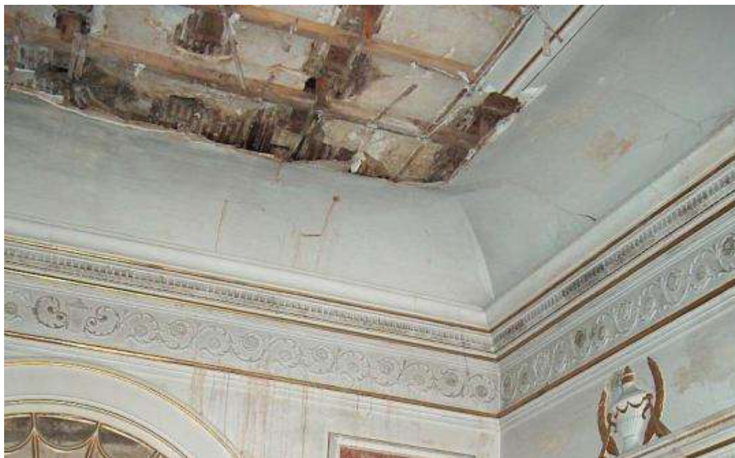
Figura 45: Aspecto do tecto com sanca em curva da sala assinalada no ponto 2. Esta sala encontra-se virada para o jardim. A realçar nesta imagem a decoração em estilo neo-clássico, bem como a degradação evidente do plano horizontal do tecto. Fonte: PPTS arquitectura, Lda.
