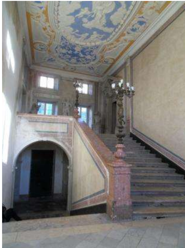
Figura 21: Escadarias nobres do Palácio dos Carvalhos. Exemplo existente e excepcional no conjunto estudado, do que seria um conjunto de escadarias monumentais. Este conjunto é já pós terramoto de 1755, durante o governo de Pombal. Fonte: fotografia do autor.
