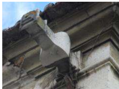
Figura 43: Gárgula do cunhal. Ponto 10 da figura 33. Gárgula em cantaria junto ao capitel do cunhal original, no extremo sul do Palácio. Fonte: fotografia do autor.
