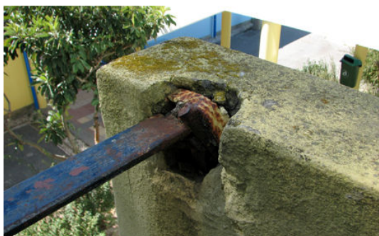
Figura 4.10: Corrosão (A12) de guarda-corpos / corrimão metálico junto ao apoio sobre murete (Escola Secundária Ferreira Dias).
