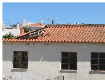
Figura 4.74: Nível 3 de sem funcionamento (A20), neste caso, a cobertura ruiu (Escola Secundária Ferreira Dias).
