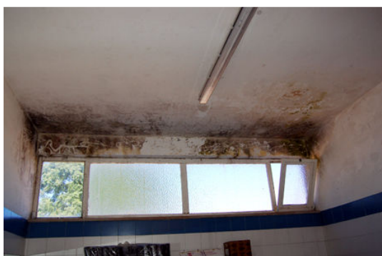
Figura 4.18: Colonização biológica (A23) em revestimento de teto e parede (Escola Secundária Rainha Santa Isabel).
