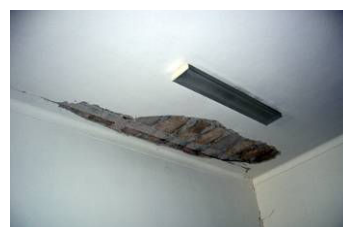
Figura 4.44: Nível 3 de descasque ou escamação (A8) de reboco de teto interior (Escola Secundária de S. Lourenço).
