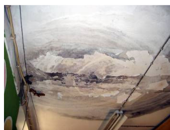
Figura 4.77: Nível 3 de infiltrações (A21) em laje de cobertura (Escola Secundária Francisco de Arruda).
