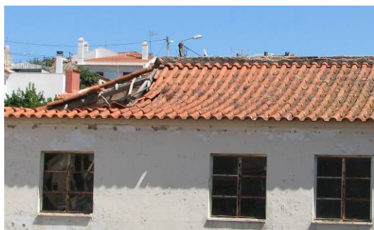
Figura 4.16: Cobertura sem funcionamento (A20) (Escola Secundária Ferreira Dias).
