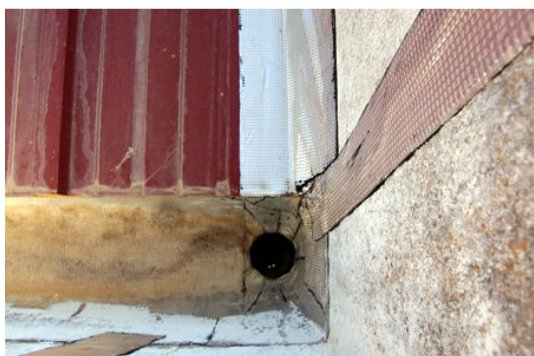
Figura 4.12: Ralo de pinha em falta (A16) na embocadura de tubo de queda do sistema de drenagem de águas pluviais (Escola Secundária Tomás Cabreira).
