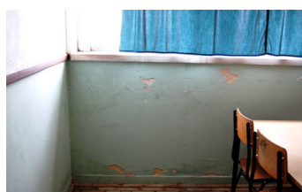
Figura 4.94: Nível 2 de empolamento (A31) de pintura em paramento interior (Escola Secundária Dr. Solano de Abreu).
