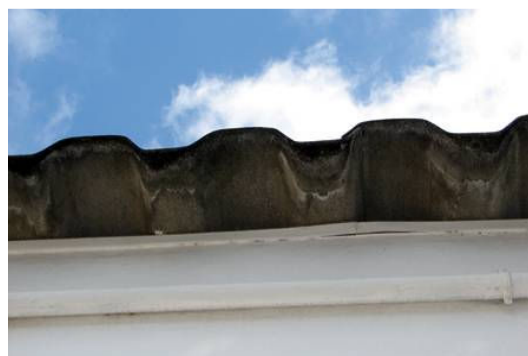
Figura 4.13: Desgaste localizado (A17) em revestimento de cobertura em placas de fibrocimento por ação da água (Escola Secundária Ferreira Dias).
