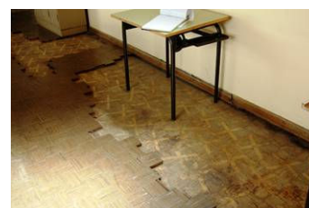
Figura 4.59: Nível 3 de elemento(s) em falta (A16) no revestimento de pavimento em tacos de madeira (Escola Secundária Rainha Santa Isabel).
