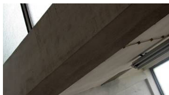
Figura 4.24: Nível 1 de sujidade diferencial (A1) em revestimento de viga das oficinas (Escola Secundária Henriques Nogueira).
