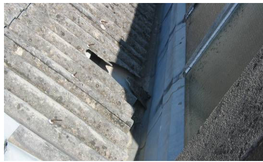
Figura 4.7: Elemento partido (A7) em revestimento de cobertura em placas de fibrocimento (Escola Secundária Jácome Ratton).
