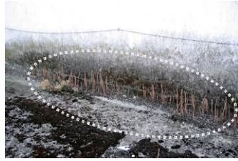
Figura 4.82: Nível 2 de vegetação parasitária (A24) em palas na fachada (Escola Secundária de S. Lourenço).
