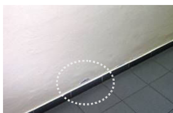
Figura 4.42: Nível 1 de descasque ou escamação (A8) em pintura de parede rebocada interior (Escola Secundária Jorge Peixinho).
