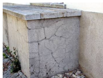
Figura 4.35: Nível 3 de fissuração mapeada (A4) em revestimento de soco em marmorite (Escola Secundária D. Manuel I).
