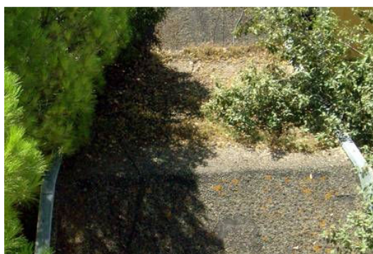
Figura 4.19: Vegetação parasitária (A24) sobre revestimento de cobertura de passagem exterior (Escola Secundária de Moura).
