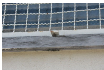
Figura 4.39: Nível 1 de fratura / elemento(s) partido(s) (A7) em peitoril em pedra (Escola Secundária Henriques Nogueira).
