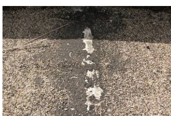
Figura 4.61: Nível 2 de desgaste localizado (A17) em tela de impermeabilização (Escola Secundária Ferreira Dias).
