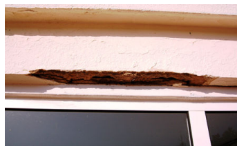
Figura 4.49: Nível 2 de corrosão (A12) em viga com armadura à vista (Escola Secundária Tomás Cabreira).
