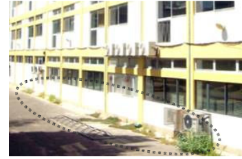
Figura 4.83: Nível 3 de vegetação parasitária (A24) em caleira de drenagem no pavimento exterior (Escola Secundária de Moura).
