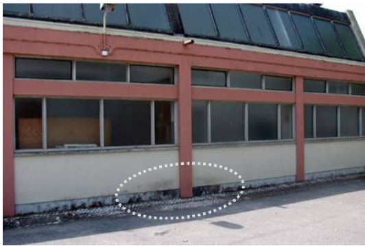
Figura 4.2: Sijidade diferencial (A1) em reboco exterior por ação de salpicos de água, devido à inexistência de tubo de queda ligado à gárgula (Escola Secundária Henriques Nogueira).
