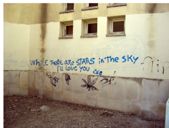
Figura 4.91: Nível 2 de graffiti (A30) em revestimentos de paramentos exteriores (Escola Secundária D. Sancho II).
