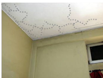
Figura 4.33: Nível 1 de fissuração mapeada (A4) em revestimento de teto (Escola Secundária Ferreira Dias).
