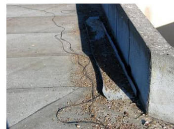
Figura 4.86: Nível 3 de detritos (A28) em cobertura em terraço (Escola Secundária de D. Sancho II).
