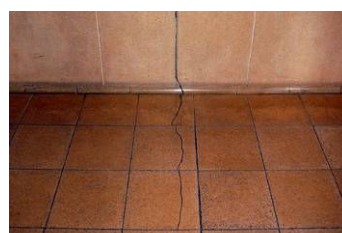
Figura 4.68: Nível 3 de deficiente funcionamento (A19), em que a junta de dilatação não tem continuidade no revestimento de pavimento, fissurando (Escola Secundária Dr. Solano de Abreu).
