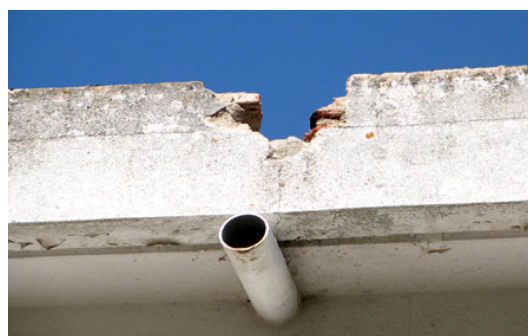
Figura 4.9: Lacuna (A10) em murete de cobertura em alvenaria (Escola Secundária D. Manuel I).
