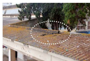
Figura 4.41: Nível 3 de fratura / elemento(s) partido(s) (A7) em revestimento de cobertura em chapa de fibrocimento (Escola Secundária Sebastião da Gama).
