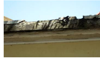
Figura 4.47: Nível 3 de lacuna em profundidade (A10) em bordo de laje de cobertura (Escola Secundária Francisco de Arruda).
