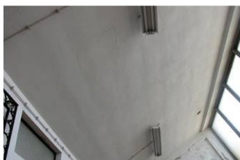
Figura 4.30: Nível 1 de descoloração ou mancha (A3) em revestimento de teto de shed (Escola Secundária Henriques Nogueira).
