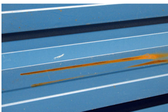
Figura 4.51: Nível 1 de corrosão (A12) em revestimento em chapa metálica de cobertura inclinada (Escola Secundária Ferreira Dias).
