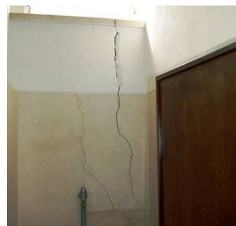
Figura 4.38: Nível 3 de fissuração orientada (A5) em parede exterior de alvenaria (Escola Secundária Dr. Solano de Abreu).
