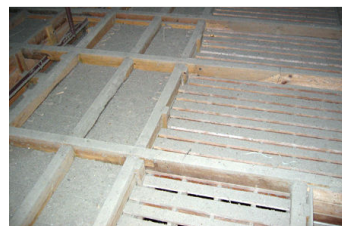
Figura 4.29: Nível 3 de sujidade uniforme (A2) em estrutura em madeira de teto falso do ginásio (Escola Secundária de S. Lourenço).
