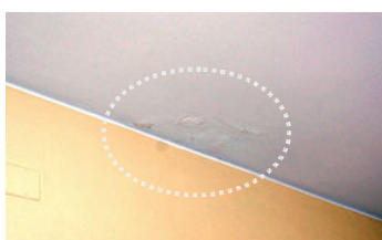
Figura 4.93: Nível 1 de empolamento (A31) de pintura em teto interior (Escola Secundária Jorge Peixinho).
