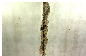
Figura 4.43: Nível 2 de descasque ou escamação (A8) de bordos de junta de dilatação (Escola Secundária Dr. Solano de Abreu).
