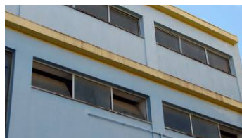
Figura 4.25: Nível 2 de sujidade diferencial (A1) em revestimento de viga saliente na fachada (Escola Secundária Ferreira Dias).
