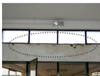
Figura 4.79: Nível 2 de colonização / ataque biológico (A23) em revestimento de paramento interior (Escola Secundária Pedro de Santarém).
