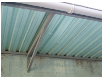
Figura 4.87: Nível 1 de deformação excessiva / assentamentos (A29) em placas metálicas na cobertura exterior de ginásio (Escola Secundária Padre Alberto Neto 13 ).
