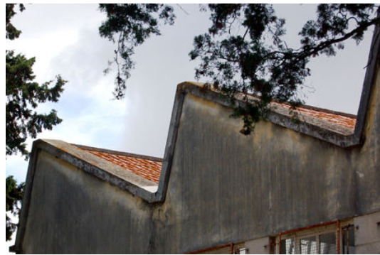
Figura 4.3: Sijidade uniforme (A2) em reboco exterior (Escola Secundária Sebastião da Gama).
