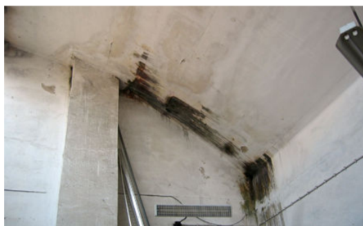
Figura 4.17: Infiltrações (A21) em laje de cobertura tipo shed (Escola Secundária Jácome Ratton).
