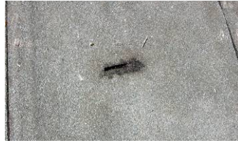
Figura 4.46: Nível 2 de lacuna em profundidade (A10) em tela de impermeabilização (Escola Secundária D. Sancho II).
