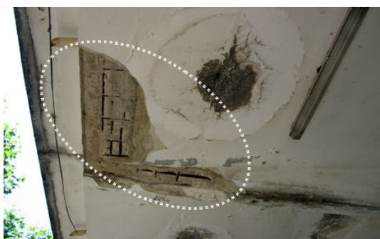
Figura 4.8: Descasque (A8) de recobrimento de laje em betão armado (Escola Secundária Francisco de Arruda).
