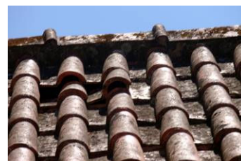
Figura 4.56: Nível 3 de elemento(s) solto(s) (A14) em revestimento de cobertura inclinada em telha cerâmica (Escola Secundária Ferreira Dias).
