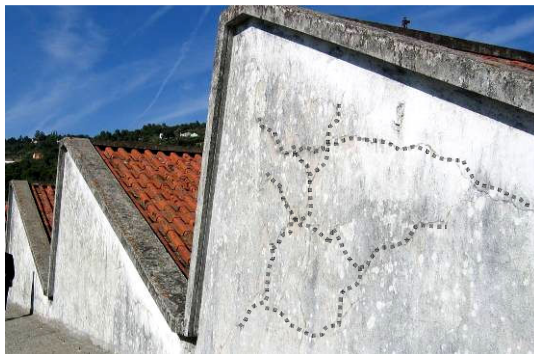
Figura 4.5: Fissuração mapeada (A4) em reboco exterior (Escola Secundária de S. Lourenço).
