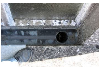
Figura 4.58: Nível 2 de elemento(s) em falta (A16), designadamente ausência de um ralo de pinha na embocadura do tubo de queda (Escola Secundária de S. Lourenço).
