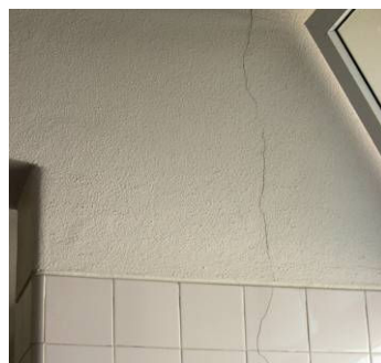
Figura 4.37: Nível 2 de fissuração orientada (A5) em parede interior de alvenaria (Escola Secundária Emídio Navarro).
