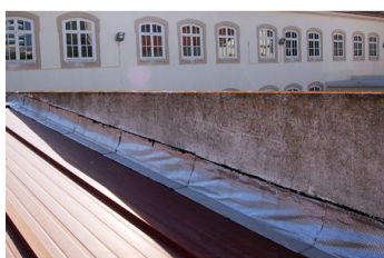
Figura 4.69: Nível 1 de deficiente funcionamento (A19), por deficiente reparação/execução de remate de cobertura com murete, que está a empolar (Escola Secundária Tomás Cabreira).
