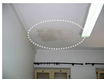
Figura 4.76: Nível 2 de infiltrações (A21) em laje de esteira (Escola Secundária Emídio Navarro).
