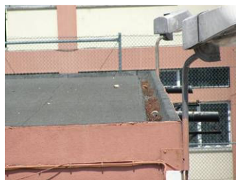
Figura 4.85: Nível 2 de detritos (A28) em caleira de cobertura em terraço (Escola Secundária Henriques Nogueira).
