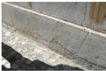
Figura 4.63: Nível 1 de desgaste uniforme (A18) em soco em pedra (Escola Secundária Sá da Bandeira 9 ).
