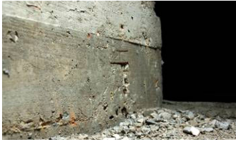
Figura 4.45: Nível 1 de lacuna em profundidade (A10) manifestando-se em vários pequenos vazios em viga de betão de laje de esteira (Escola Secundária Pedro de Santarém).
