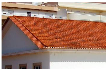
Figura 4.28: Nível 2 de sujidade uniforme (A2) em revestimento de cobertura inclinada em telha cerâmica (Escola Secundária Tomás Cabreira).
