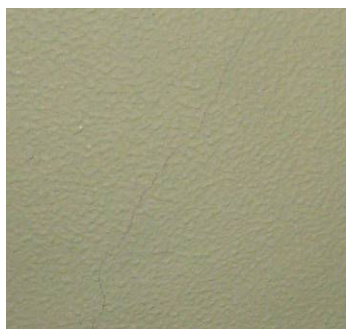
Figura 4.36: Nível 1 de fissuração orientada (A5) em parede interior de alvenaria (Escola Secundária Henriques Nogueira).
