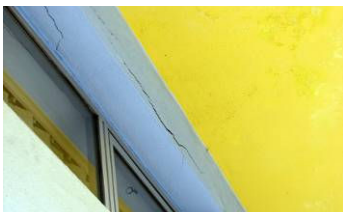
Figura 4.48: Nível 1 de corrosão (A12) pela fissura no sentido da armadura da viga de betão armado (Escola Secundária Ferreira Dias).
