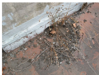
Figura 4.73: Nível 2 de sem funcionamento (A20) do tubo de drenagem de cobertura em terraço (Escola Secundária Eça de Queiroz 12 ).
