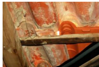
Figura 4.65: Nível 3 de desgaste uniforme (A18) de telhas cerâmicas em cobertura inclinada (Escola Secundária João de Deus 10 ).
