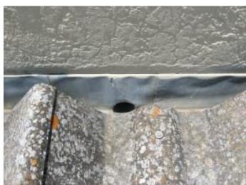
Figura 4.72: Nível 1 de sem funcionamento (A20) do tubo de drenagem de calçada periférica (Escola Secundária Diogo de Gouveia 11 ).
