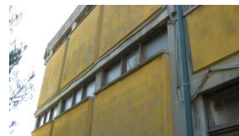
Figura 4.26: Nível 3 de sujidade diferencial (A1) em revestimento de paramento na fachada (Escola Secundária de Santo André).
