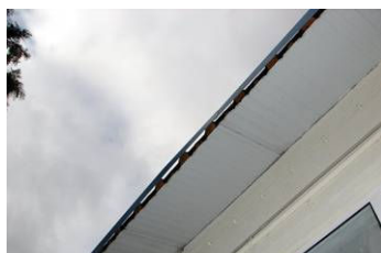
Figura 4.54: Nível 1 de elemento(s) solto(s) (A14), no caso um perfil metálico de remate de revestimento de cobertura (Escola Secundária Ferreira Dias).
