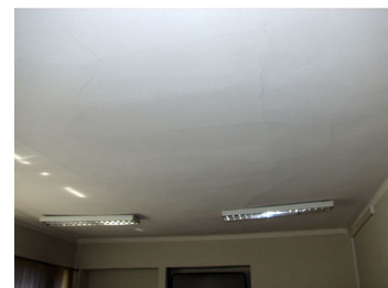
Figura 4.89: Nível 3 de deformação excessiva / assentamentos (A29) de teto falso, devido ao mau funcionamento da cobertura (Escola Secundária Ferreira Dias).
