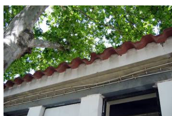
Figura 4.40: Nível 2 de fratura / elemento(s) partido(s) (A7) em revestimento de cobertura em chapa de fibrocimento (Escola Secundária Emídio Navarro).
