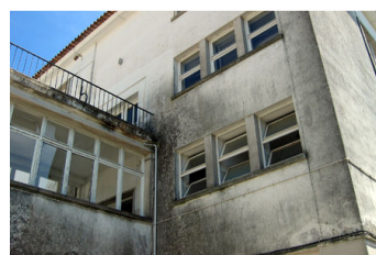
Figura 4.71: Nível 3 de deficiente funcionamento (A19) do sistema de drenagem da cobertura plana acessível, provocando danos no revestimento de fachada (Escola Secundária de S. Lourenço).
