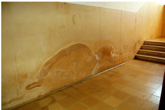
Figura 4.4: Mancha (A3) em lambril em marmorite devido a infiltrações pelo tardo de parede enterrada (Escola Secundária Dr. Solano de Abreu).
