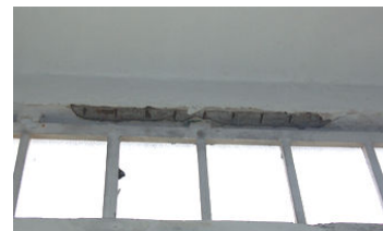
Figura 4.50: Nível 3 de corrosão (A12) em armadura de viga (Escola Secundária Sebastião da Gama).
