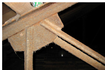
Figura 4.52: Nível 2 de corrosão (A12) em estrutura metálica de suporte de cobertura (Escola Secundária Emídio Navarro).
