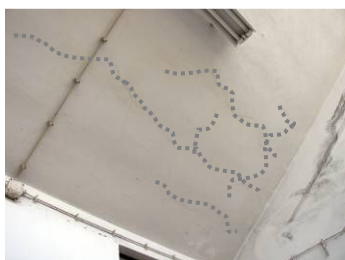
Figura 4.34: Nível 2 de fissuração mapeada (A4) em revestimento de teto de shed em oficina (Escola Secundária Henriques Nogueira).
