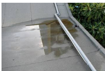
Figura 4.70: Nível 2 de deficiente funcionamento (A19) do sistema de drenagem por pendente insuficiente de cobertura, levando à acumulação de água (Escola Secundária Ferreira Dias).
