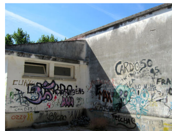
Figura 4.92: Nível 3 de graffiti (A30) sobre revestimento de paramento exterior (Escola Secundária de S. Lourenço).
