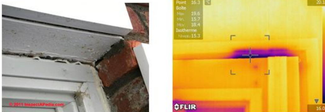
Figura 3.9 - Folga entre aro e vão excessiva (à esquerda) (InspectAPedia, 2012); imagem termográfica - transmissão elevada de calor através da junta entre aro e folha (à direita) (Thermography, 2012)
