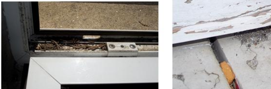
Figura 3.15 - Acumulação de folhas no caixilho (à esquerda) e obturação dos rasgos drenantes (à direita)
