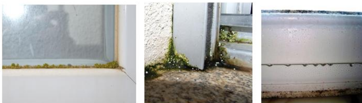
Figura 3.17 - Colonização biológica na face exterior da caixilharia (à esquerda e ao centro) e no mastique da face interior da caixilharia (à direita)
