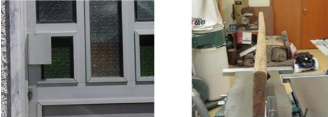
Figura 3.8 - Porta encravada por dilatação do caixilho (à esquerda) (Brito, 2005) e empeno em caixilharia de madeira (à direita) (Gomes, 2009)
