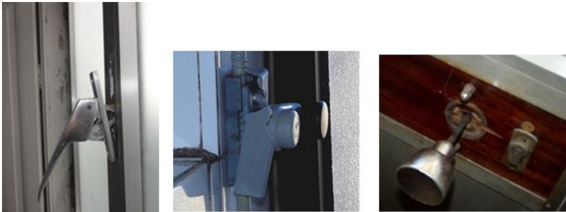
Figura 3.14 - Mecanismos de fecho danificados
