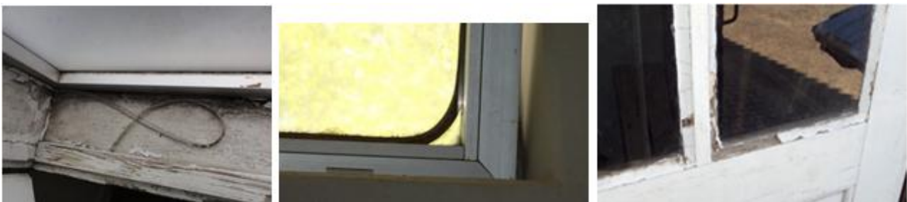
Figura 3.5 - Descolamento de mastiques (à esquerda), cordão de estanqueidade mal colocado (ao centro) e desprendimento da massa de vidraceiro à direita
