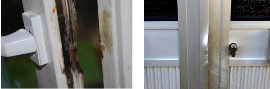
Figura 3.25 - Caixilharias danificadas por arrombamento
