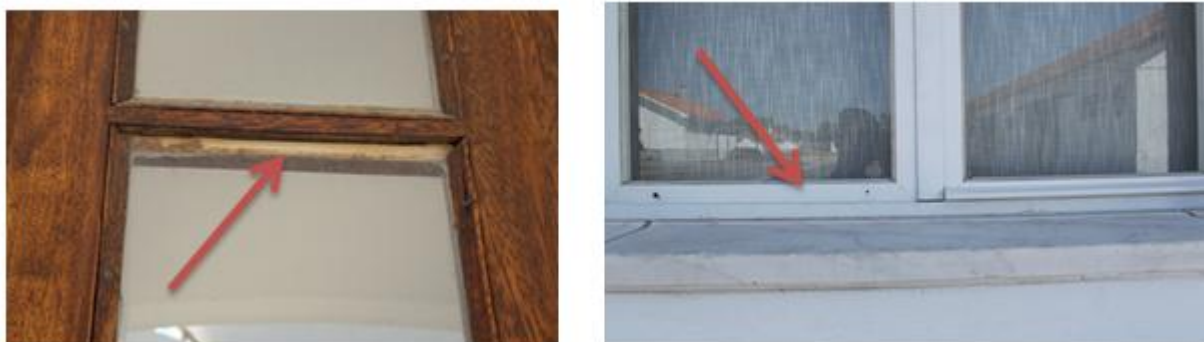
Figura 3.6 - Ausência de bite (à esquerda) e ausência de pingadeira (à direita)
