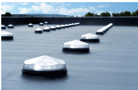
Fig. 3.3.1.11.7. Cobertura de superfície comercial com instalação de tubos solares
