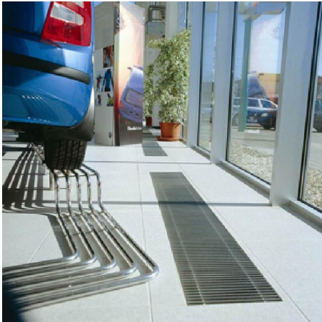
Fig.3.3.1.10.1. Arrefecimento por tubos enterrados – stand de automóveis; França
