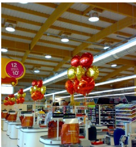
Fig. 3.3.1.11.8. Interior de superfície comercial iluminada através de tubos solares
