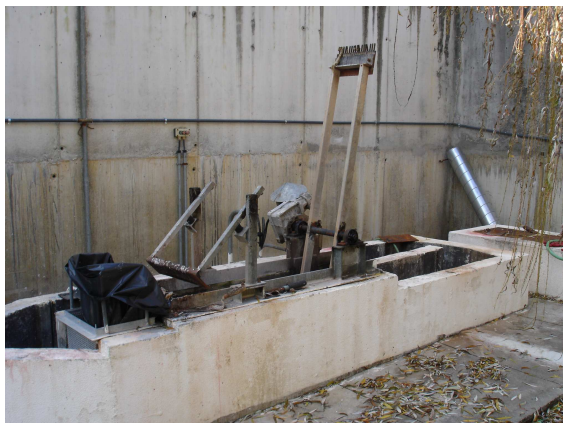
FIGURA V: Câmara de Grades com limpeza mecânica
