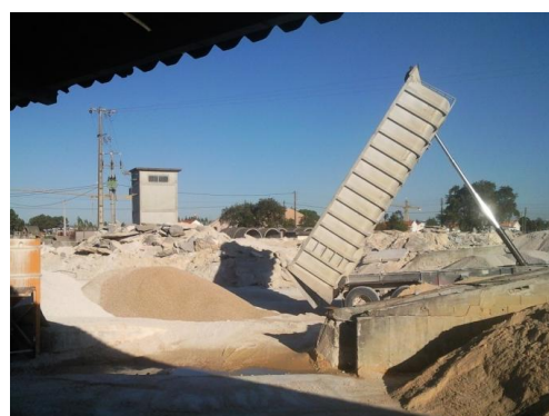
Figura 7.4 – Ausência de verificação do local de descarga/armazenamento dos agregados.
