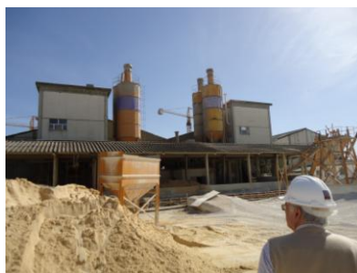
Figura 3.1 – Silos de cimento referentes a duas centrais de betão (empresa Pavilis Pré-Fabricação S.A. ).
