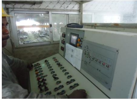
Figura 4.3 – Controlo automático do processo de dosagem e mistura.
