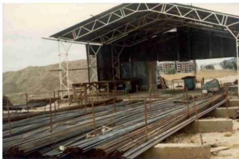
Figura 3.8 – Armazenamento das armaduras evitando o contacto com o solo (Execução de Estruturas de Betão).
