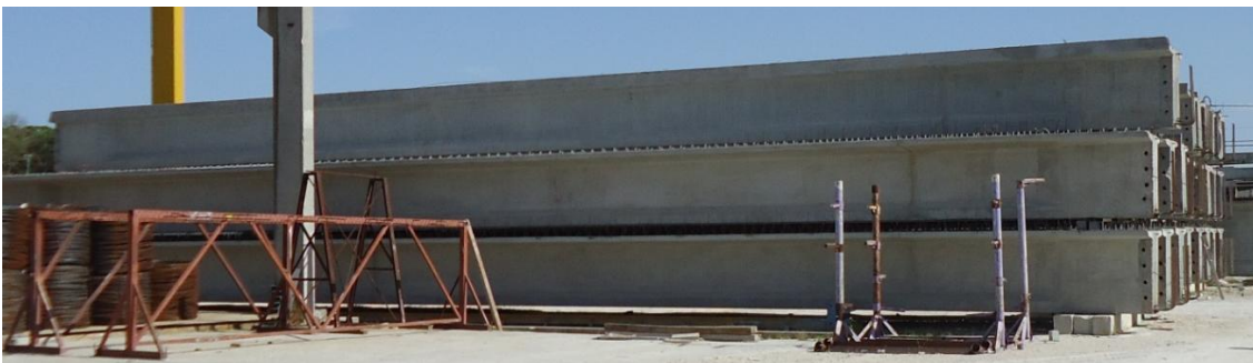
Figura 7.17 – Armazenamento das peças sem protecção das esquinas.
