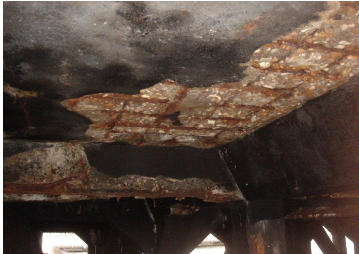
Figura 4.1 – Exemplo de corrosão com delaminação na parte inferior da laje de uma estrutura situada no estuário do Tejo (Arquivo pessoal).
