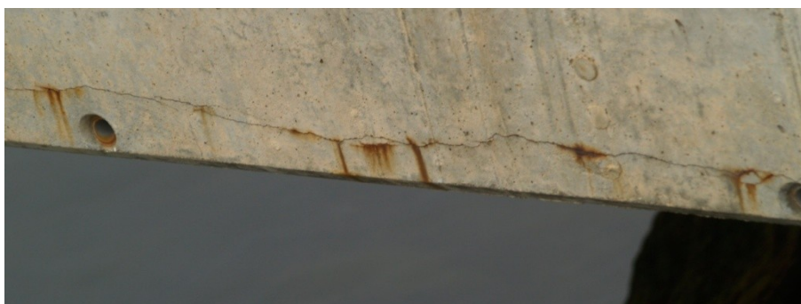
Figura 5.35 – Degradação nível 1 (fissuração e alteração cromática) na PCE PE 7 (arquivo pessoal).
