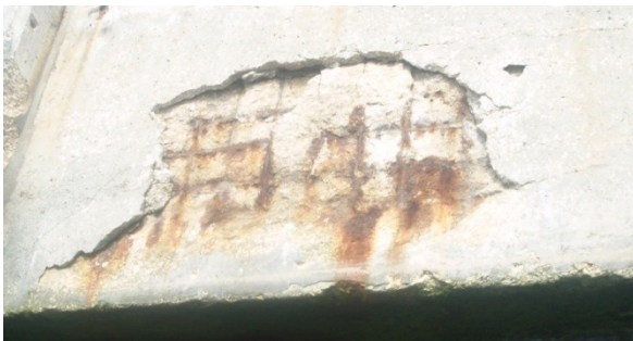
Figura 5.38 – Delaminação no CD NA 1 (arquivo pessoal).
