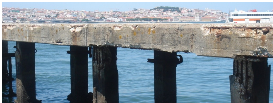
Figura 3.12 – Degradação provocada pela presença de consola curta na laje da estrutura (Arquivo pessoal).
