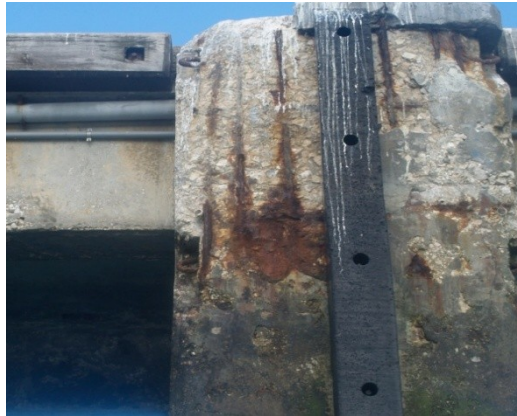
Figura 5.37 – Delaminação acentuada na PCE NA 1 Nascente (arquivo pessoal).
