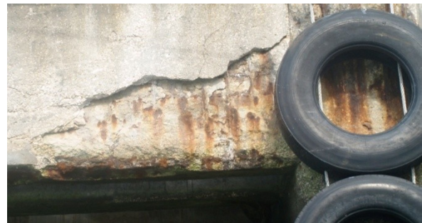
Figura 5.39 – Delaminação no CD NA 1 (arquivo pessoal).
