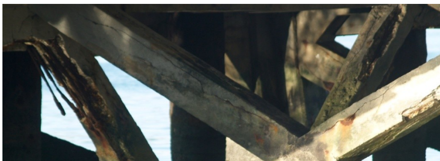
Figura 5.22 – Corrosão em pilar interior da PC PO (arquivo pessoal).
