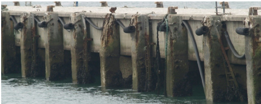
Figura 5.33 – Degradação na PCE PE do 3 lado Nascente (arquivo pessoal).
