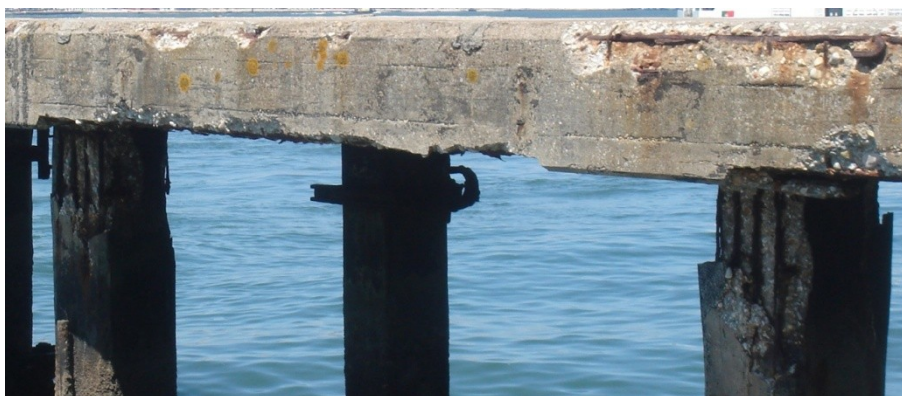
Figura 5.26 – Delaminação de nível 3 no topo dos pilares da PC CA 3, zona atmosférica (arquivo pessoal).
