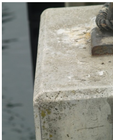
Figura 3.11 – Acabamento aconselhável na execução de arestas salientes de pilares e lajes (Arquivo pessoal).
