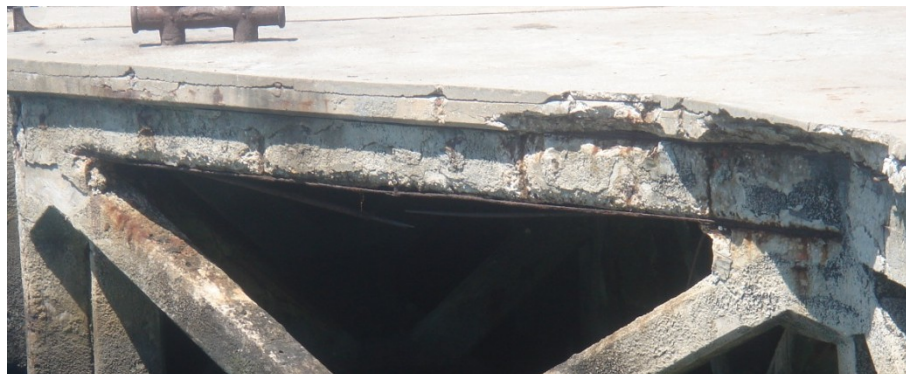
Figura 5.27 – Delaminação do lado Poente da PC CA 2 (arquivo pessoal).
