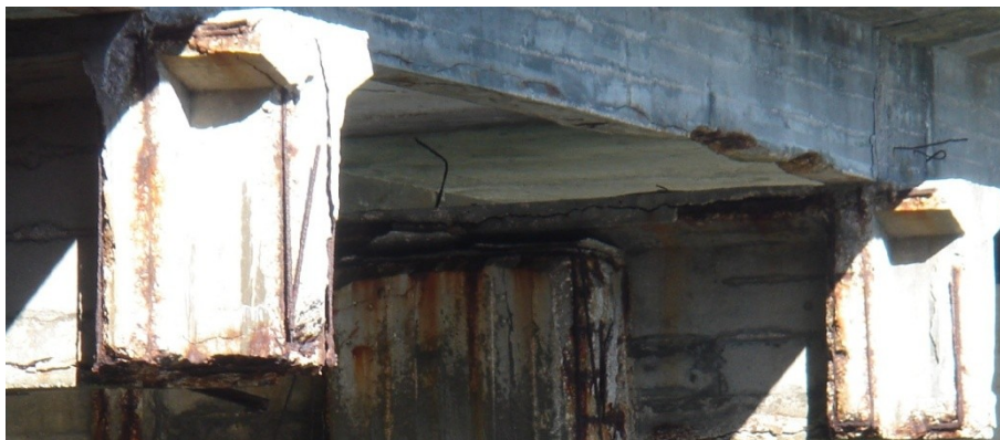
Figura 5.30 – Exemplo de corrosão e perda de secção de nível 3 no Terminal de PB (arquivo pessoal).
