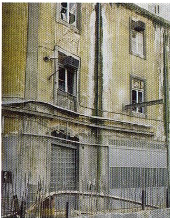
FIGURA 13. CONSEQUÊNCIA DO REBAIXAMENTO DO NÍVEL FREÁTICO, ASSOCIADO À DESCOMPRESSÃO DO TERRENO [3].
