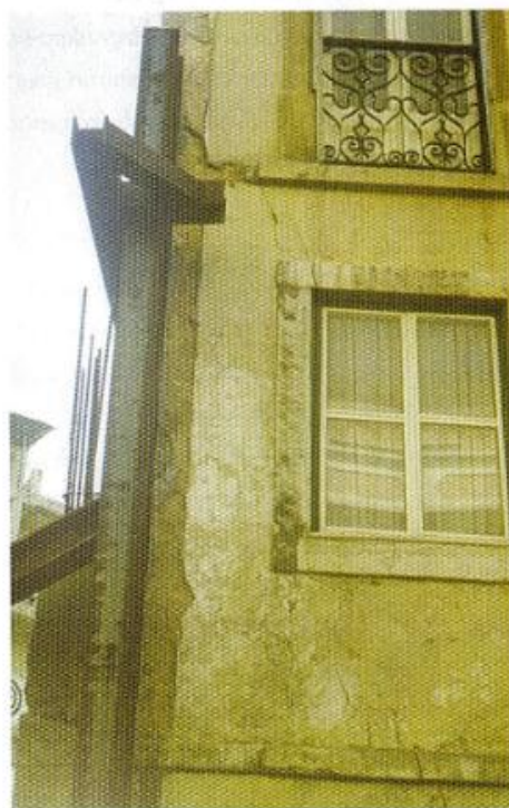
FIGURA 14. ASSENTAMENTO DE FUNDAÇÃO DEVIDO A DESCOMPRESSÃO DO SOLO, NA SEQUÊNCIA DE ESCAVAÇÃO ADJACENTE [3].
