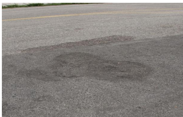
Figura 5.10 Depressão significativa, numa secção com outra anomalia também evidente (Desagregação da superfície)
