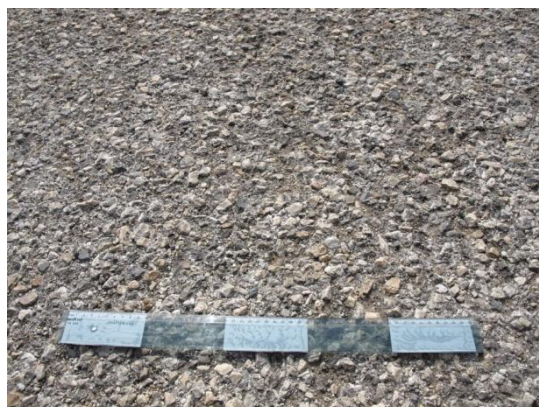
Figura 5.2 Desagregação superficial (nível 2)
