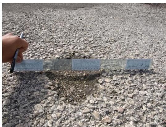
Figura 5.25 Buraco com 2cm de profundidade, mas limitado na área, com outras anomalias na secção (nível 1 ou 2)
