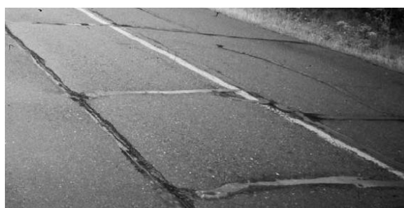
Figura 5.15 Fendas de reflexão do pavimento inferior, extraída de (U. S. Department of Transportation, 2004)
