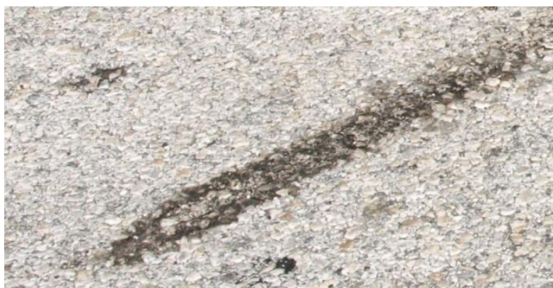
Figura 5.29 Rasgo provocado por arrastamento de elemento metálico, pouco significante (nível 1)
