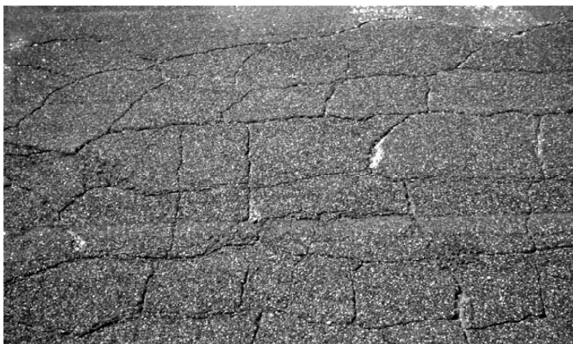
Figura 5.20 Fendas cruzadas formando blocos e abertas, permitindo a entrada de água, extraída de (U. S. Department of Transportation, 2004)
