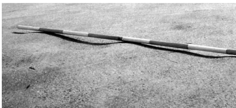
Figura 5.8 Ondulações significativas da superfície do pavimento, extraída de (U. S. Department of Transportation, 2004)
