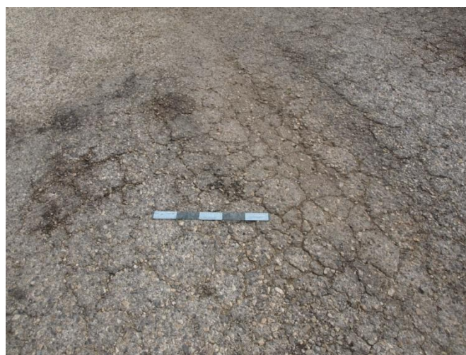
Figura 5.22 Pele de crocodilo extensa e claramente condicionante da classificação da secção (nível 2)
