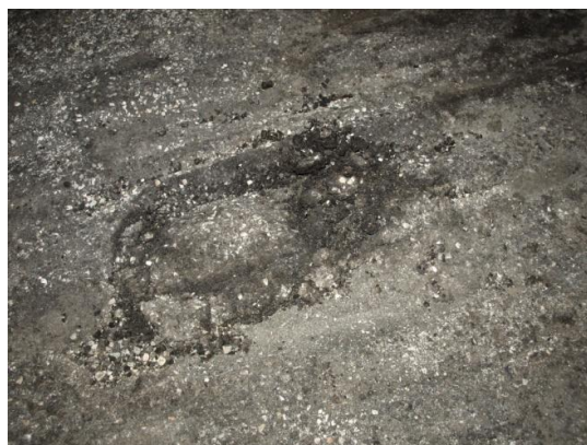
Figura 5.30 Depressão provocada por impacto mecânico, com forte desagregação (nível 2)
