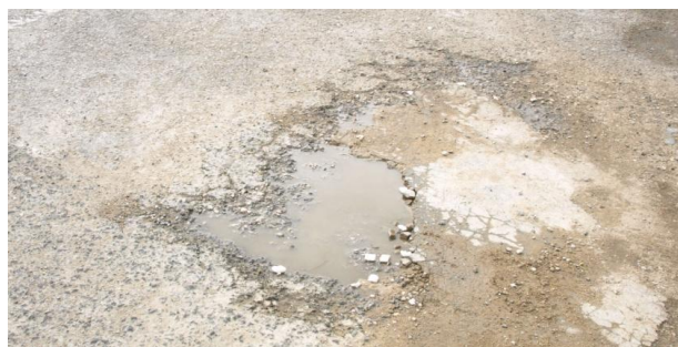
Figura 5.26 Buraco com 2cm de profundidade mas de área significativa e desagregação importante (nível 2)
