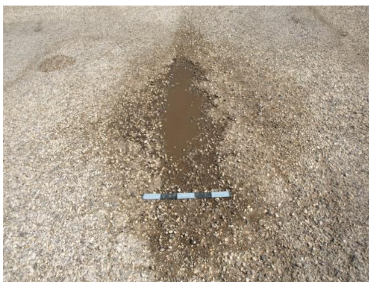
Figura 5.18 Fendas e deterioração avançada na junta do pavimento (nível 2)
