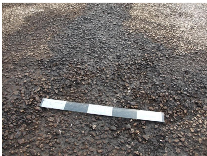
Figura 5.28 Derrame significativo de óleos na secção (nível 2)
