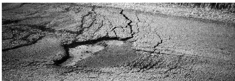
Figura 5.16 Fendas de escorregamento lateral, com forte desagregação, extraída de (U. S. Department of Transportation, 2004)
