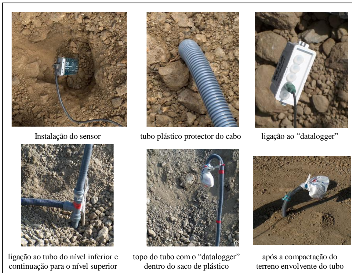
Figura 3.20 – Instalação dos sensores ECH 2 O (Maranha das Neves & Cardoso, 2006)
