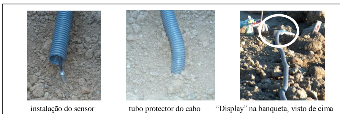
Figura 3.21 – Instalação dos sensores HMT 337 (Maranha das Neves & Cardoso, 2006)
