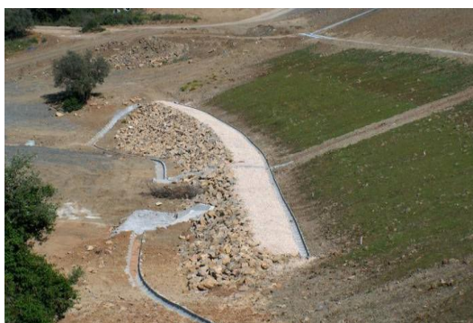
Figura 3.2 – Dreno no pé do talude e revestimento de taludes com terra vegetal
