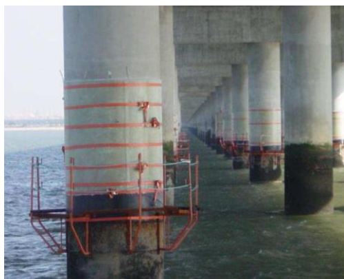
Figura 8 - Aplicação do sistema APE na ponte Vasco da Gama (Appleton e Costa, 2009)
