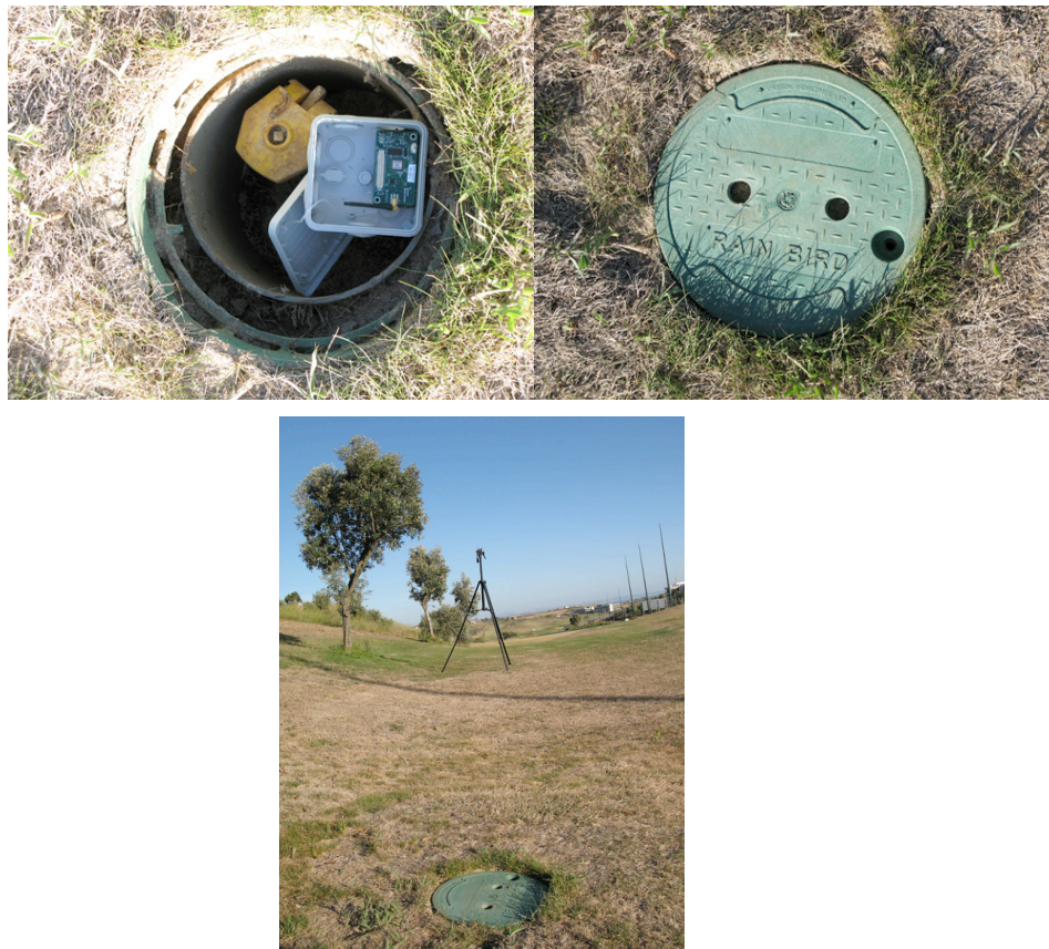
Figura 19 – Emissor dentro de caixa de sistema de rega
