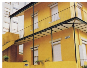
Fig. 31 – Vista do sistema de circulação exterior em galeria
