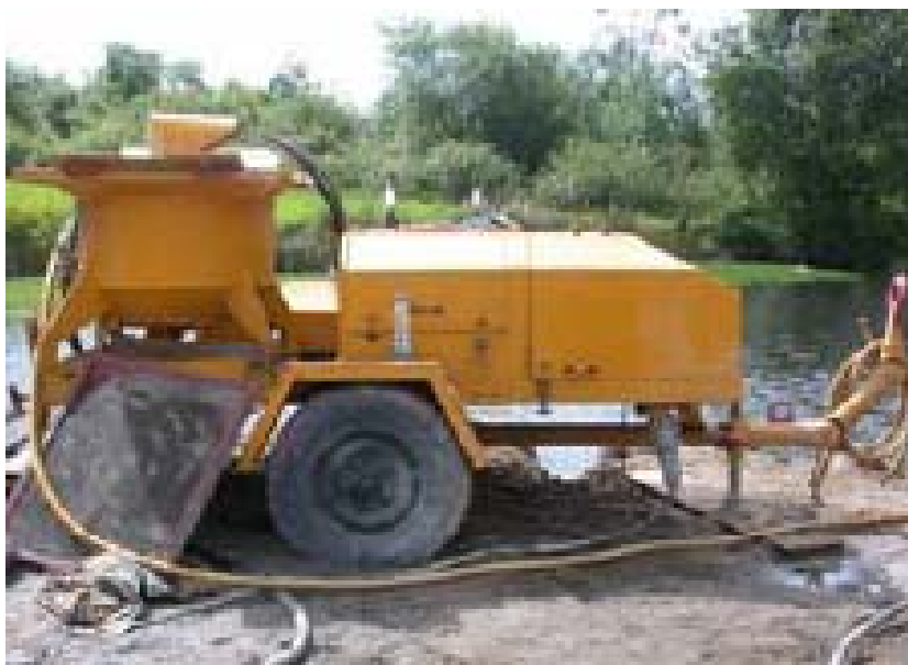
Figura 4.33 – Central de bombagem
