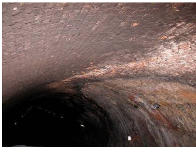
Figura 3.6 – Deformação na abóbada entre o Pk [1+564 ; 1+594] [10]
