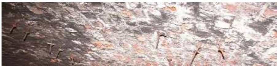
Figura 3.7 – Outra vista da deformação na abóbada entre o Pk [1+564 ; 1+594] [10]
