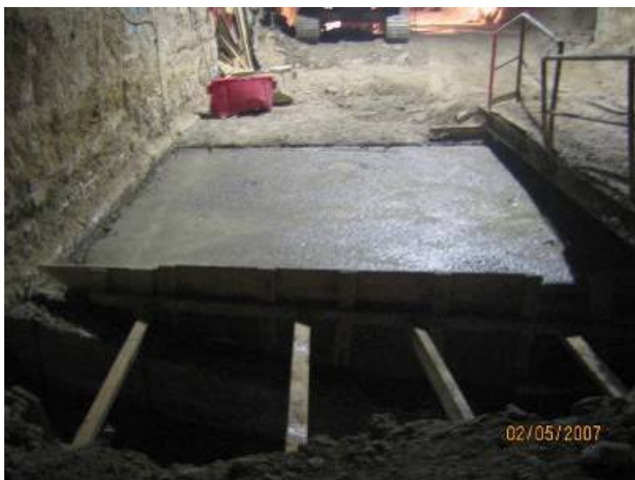
Figura 4.65 – Betonagem (C12/15) do troço de soleira da secção de alvenaria a manter
