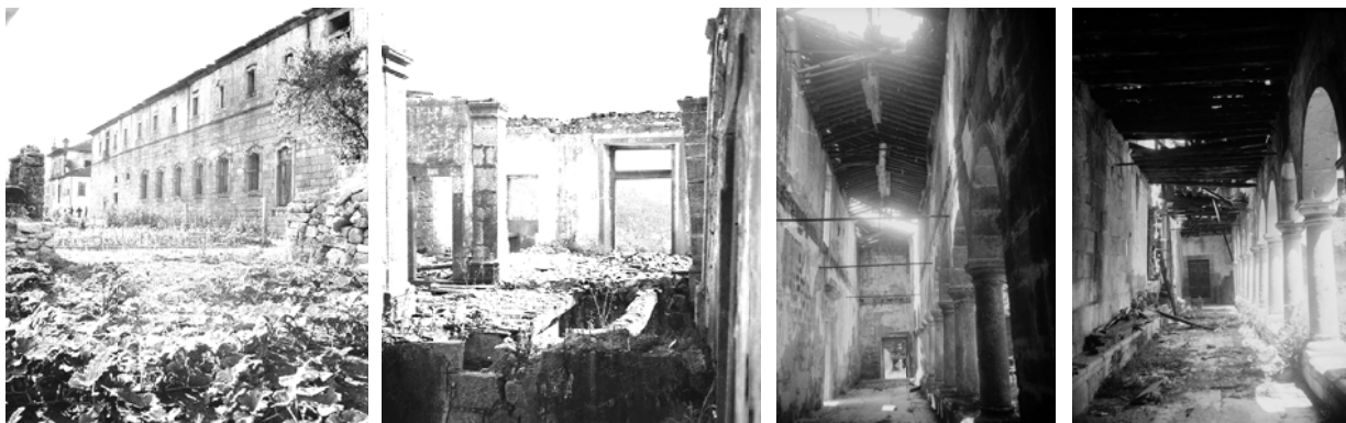
Figura 14 Estado de ruína do mosteiro em 1962, na primeira figura, e 1984 nas restantes. (fonte: DGEMN)
