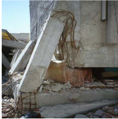
Figura 2.36 – Má pormenorização das armaduras.
