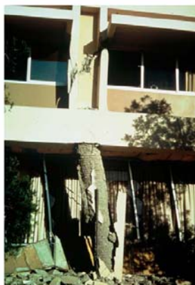
Figura 2.33 – Perda de betão de recobrimento de um pilar
