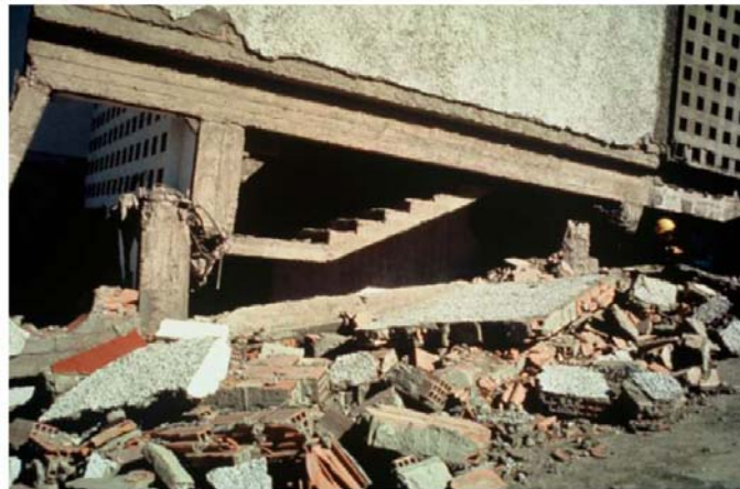
Figura 2.28 – Colapso de um pilar devido às escadas.
