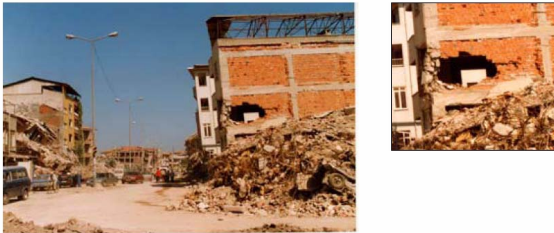
Figura 2.3 – Punçoamento a meia altura de um pilar devido ao choque do pavimento de um edifício adjacente. Sismo na Turquia em Agosto de 1999.
