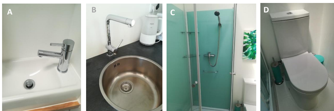
Figura 18 - Fotografias dos equipamentos responsáveis pelo consumo de água nos bungalows (A- toneira lavatório; B- torneira lava-loiças; C- Sistema de duche; D- autoclismo).
