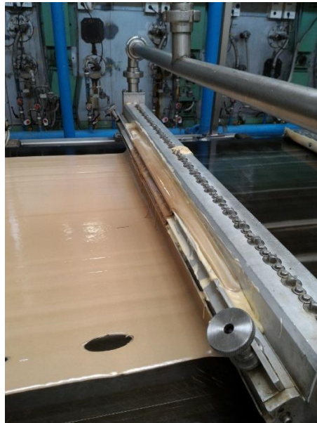
Figura 39 – Imagem real dos problemas causados pelas folgas na depositadora.
