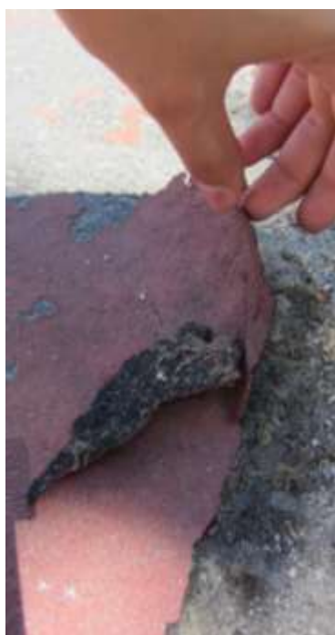
Figura 3.17- Desagregação do revestimento
