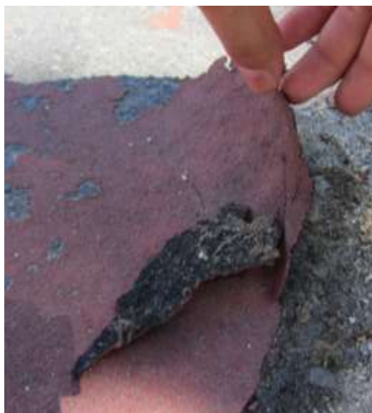
Figura 5.14- Desagregação do revestimento
