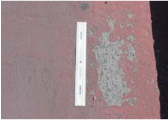
Figura 5.9- Desagregação superficial em A1
