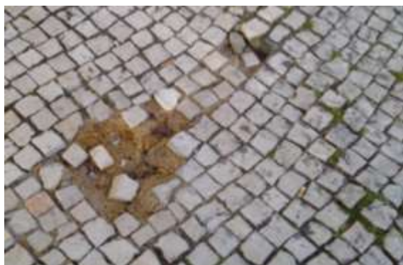
Figura 3.15- Degradação devido à queda de água num local concentrado
