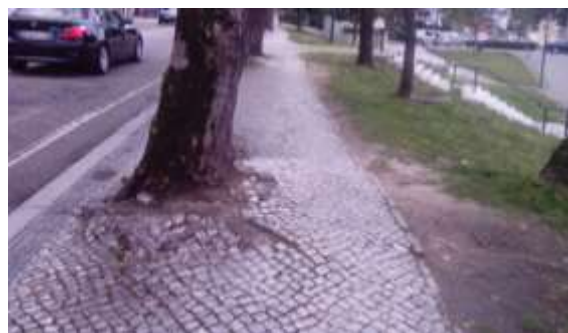
Figura 3.14- Desagregação de blocos devido às raízes dos elementos arbóreos
