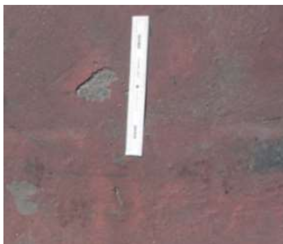
Figura 5.8- Pelada e manchas no revestimento em A1
