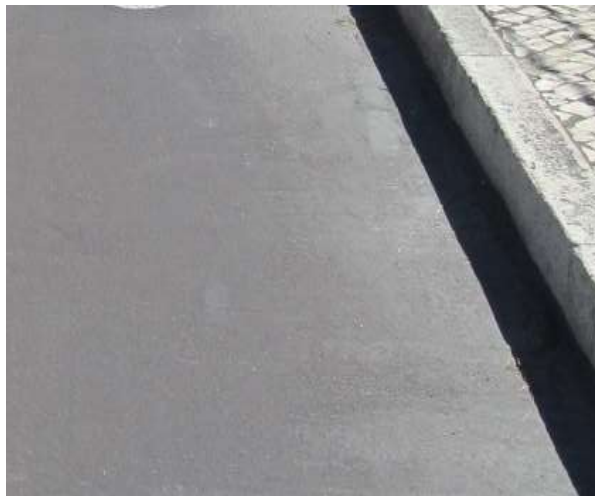
Figura 5.11- Zona mais degradada junto ao lancil em A2
