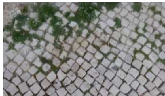
Figura 3.13- Irregularidade da superfície e aparecimento de vegetação
