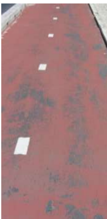
Figura 3.18- Pista ciclável com peladas no revestimento
