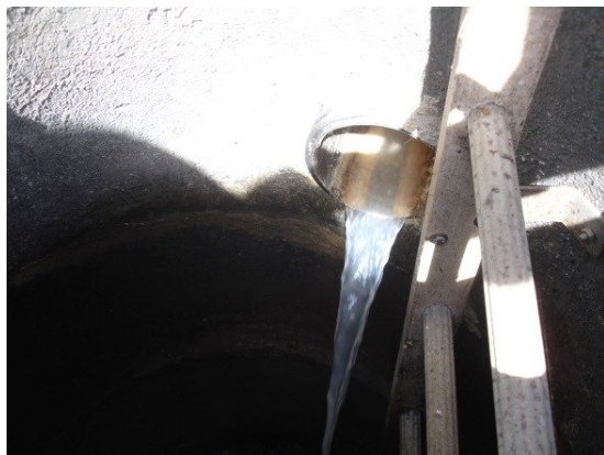
Figura 21 – Colector que descarga o efluente da indústria na rede de drenagem
