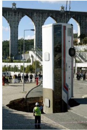
Figura 3.2 - Colapso de coletor de águas residuais e pluviais do caneiro de Alcântara em 2003 ( http://www.cmjornal.xl.pt/nacional/portugal/detalhe/bucaro-engole-autocarro--em-campolide.html acedido em 02/12/2014)
