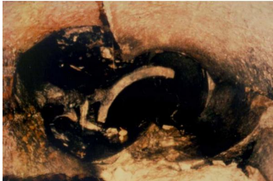
Figura 4.2 - Colapso de um coletor (EN13508-2:2003)
