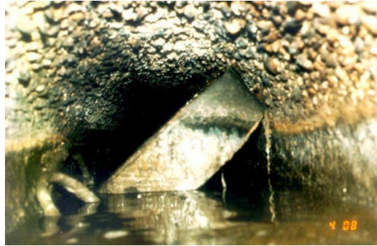
Figura 4.1 - Obstrução de coletor gerada por obstáculo (EN13508-2:2003)
