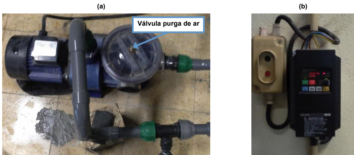
Figura 4 – Sistema composto pelo grupo eletrobomba (a) e respetivo variador de frequência (b).
