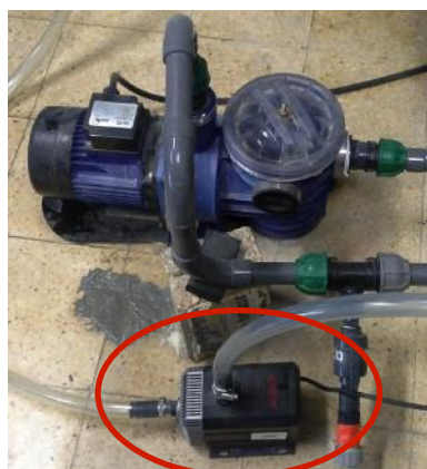
Figura 5 – Bomba auxiliar ligada ao circuito.
