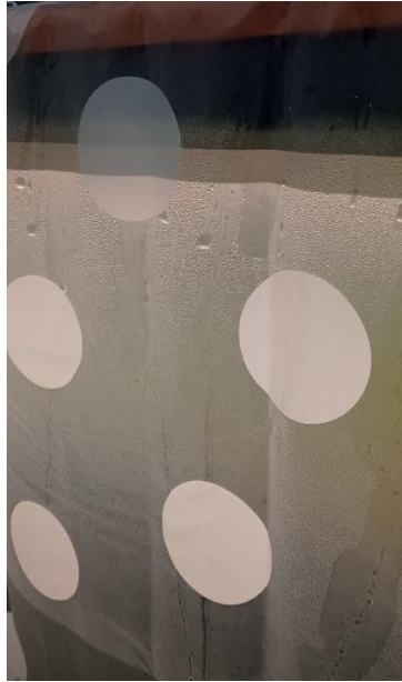
Figura 18. Condensação visível no interior da separatória de plástico, indicativa de um excesso de humidade relativa no interior do módulo.
