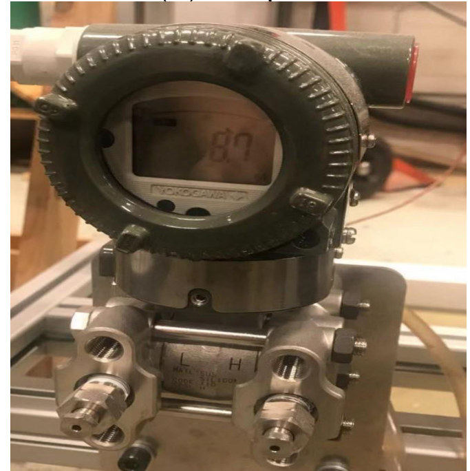
(d) Differential Pressure Transmitter
